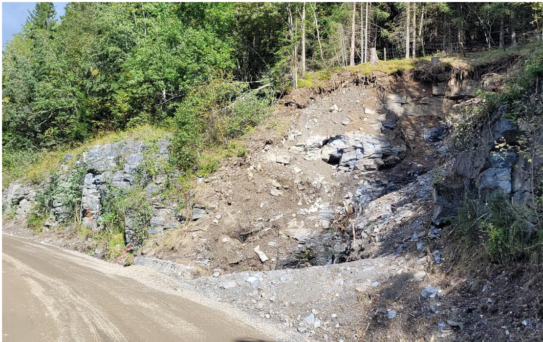
Kulvert som gikk tett ovenfor Kårstad. Her etter en del opprydding og istandsetting av veien etter skadene. Kulverten var ikke tilstrekkelig åpnet igjen på befaringstidspunktet. Massene har kommet fra både veien/grøft oppstrøms, samt i skråningen rett ovenfor kulverten. Lite erosjon og massetransport å observere i selve bekkeløpet ovenfor/til høyre for bildet.
