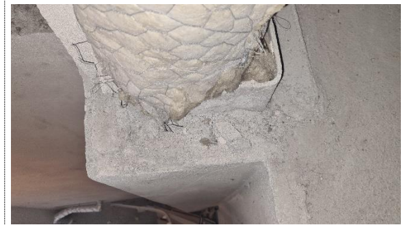
Bilde nr. 2.10 Bygg 1, nyere vertikale kanaler i knuste eternitkanaler.
