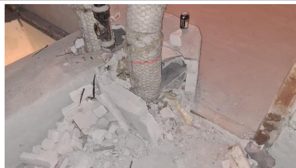
Bilde nr. 2.11 Bygg 1, knuste eternitplater i murte kanaler.
