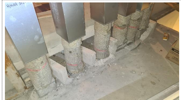
Bilde nr. 2.12 Bygg 1, murte kanaler med eternit er knust for montering av nyere kanaler.
