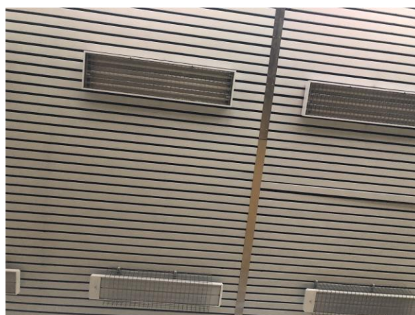
Bilde B10: Kontrollområde 8 i 1. etasje Gymsal rom 141
