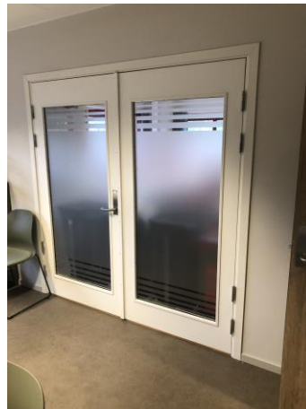
Bilde 2: Kontrollområde 2 Dør mellom rom 214 og 213 i 2. etasje Dør oppgis å være fra ombygging i 2020
