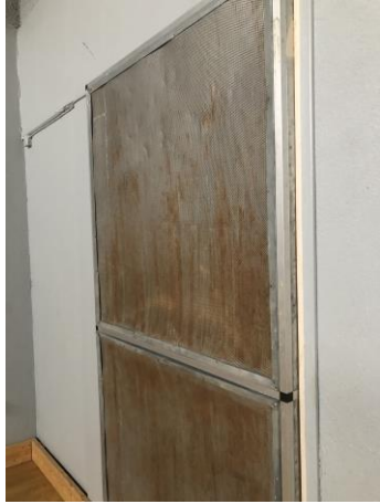
Bilde B11: Kontrollområde 8 i 1. etasje Gymsal rom 141
