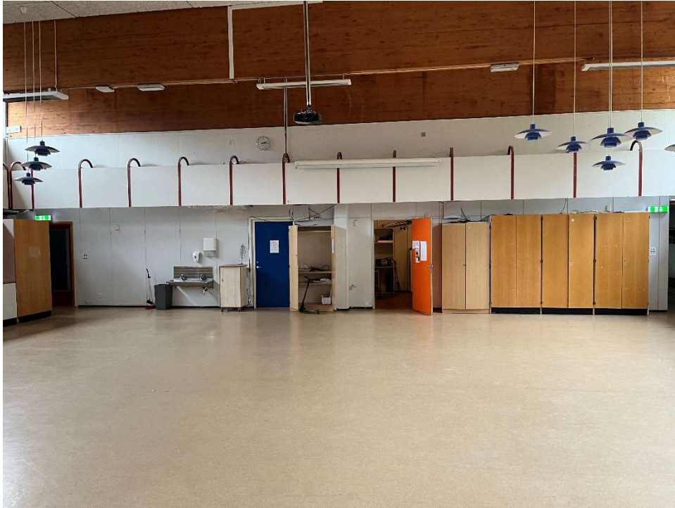
Figur 9 - Hvite asbestplater i røde bøyler skjermer for ventilasjonskanaler.
