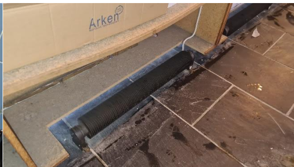
Bilde 12 – Elvarme bak garderobedisk.
