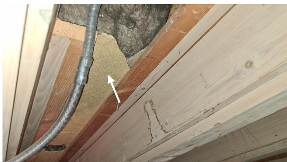
Bilde 1 – Knust internit i stubbloft (pil).
