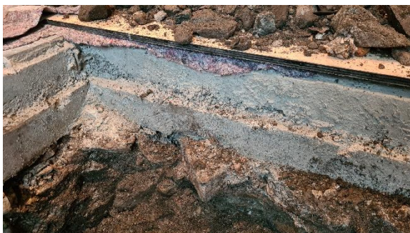
Bilde 5 – Dobbelt betonggulv i herretoalettet.
