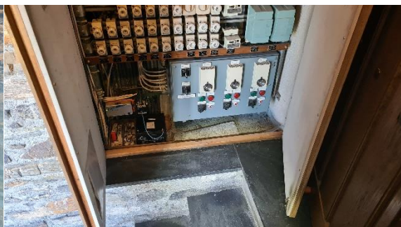
Bilde 4 – Asbestoluxplater på innsiden av dører til sikringsskap ved Håkonshallen, venstre side.
