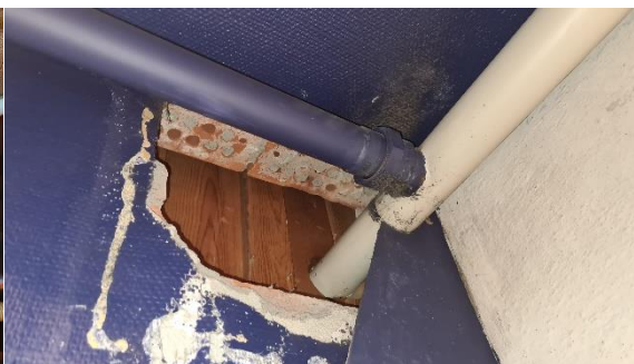
Bilde 8 – Hull i teglvegg, hulltegl med sementmørtel.
