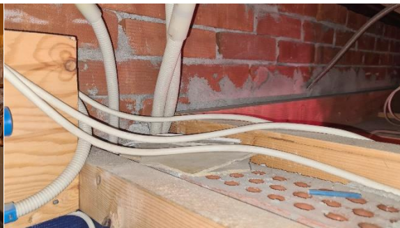
Bilde 10 – Diverse installasjoner over himling i toaletter.
