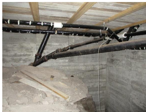
Bilde 11: Soilrør i krypkjeller
