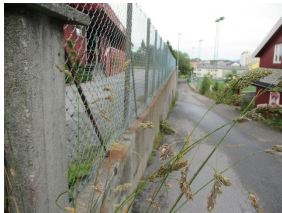
Bilde 39: Støttemur. Prøve P19. Kan nyttiggjøres uten søknad.
