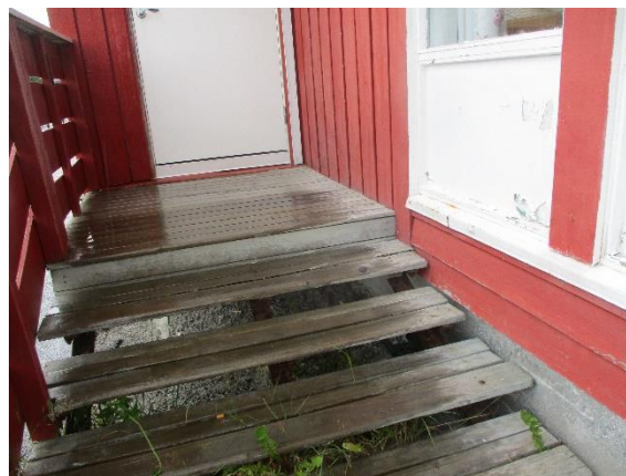
Bilde 17: Trapp med CCA-impregnert trevirke
