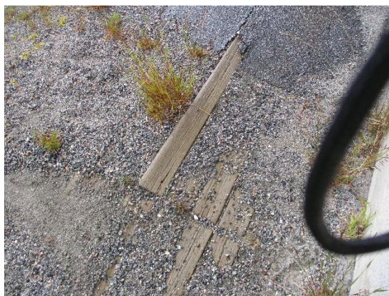
Bilde 21: CCA-impregnert materiale skjult under grus
