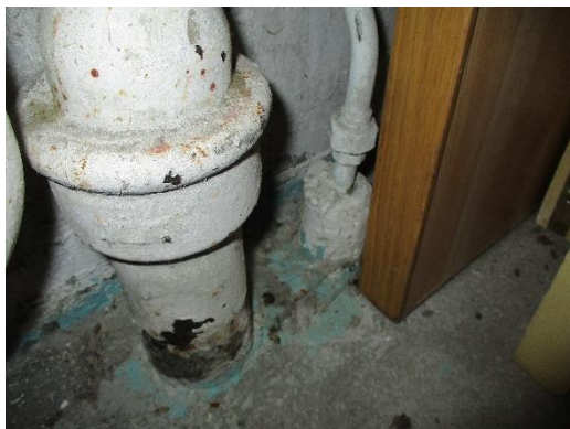
Bilde 8: Soilrør i bomberom
