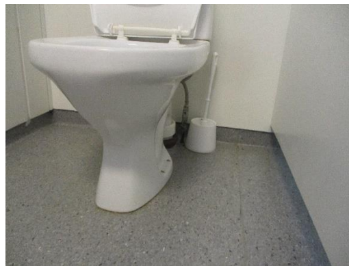
Bilde 9: Soilrør bak toalett
