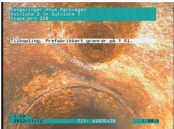
SP Bunnledning 4_Gulvluke 2_Gulvluke 1_14112022_084127_031.jpg, 00:00:40, 1.88m Tilkopling. Prefabrikkert grennrør på 1 Kl. / Anslått plugget?
