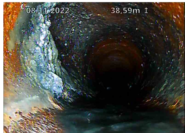
SP Bunnledning 2_Gulvluke 3_DE 1_08112022_071922_020.jpg, 00:06:41, 38.59m Tilkobling. Prefabrikkert grenrør på 10 Kl. / TKP 45
