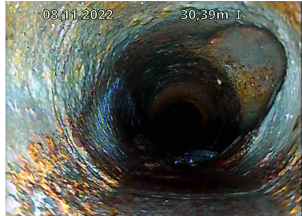
SP Bunnledning 2_Gulvluke 3_DE 1_08112022_071922_018.jpg, 00:05:15, 30.39m Tilkobling. Prefabrikkert grenrør på 2 Kl. / TKP27, TKP 26, TKP 24, TKP 23 og TKP 28
