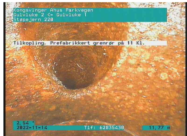
SP Bunnledning 4_Gulvluke 2_Gulvluke 1_14112022_084127_036.jpg, 00:03:53, 11.77m Tilkobling. Prefabrikkert grenrør på 11 Kl. / Ikke funnet tilhørighet
