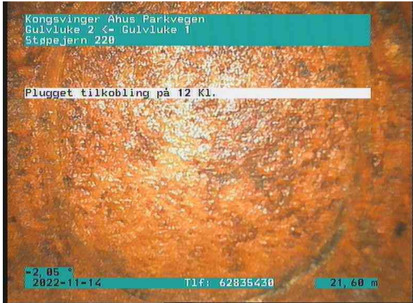
SP Bunnledning 4_Gulvluke 2_Gulvluke 1_14112022_084127_045.jpg, 00:07:09, 21.60m Plugget tilkobling på 12 Kl. / Ukjent lokasjon på stakeluke, mistenker at den er støpt over
