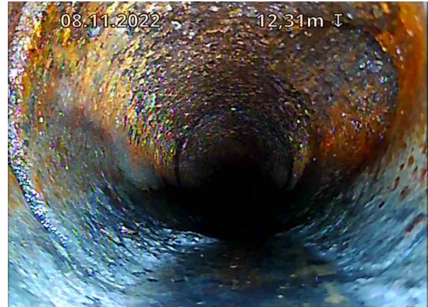
SP Bunnledning 2_Gulvluke 3_DE 1_08112022_071922_014.jpg, 00:02:25, 12.31m Tilkobling. Prefabrikkert grenrør på 2 Kl. / TKP 15
