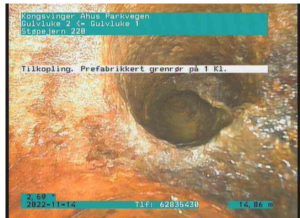
SP Bunnledning 4_Gulvluke 2_Gulvluke 1_14112022_084127_040.jpg, 00:05:06, 14.86m Tilkobling. Prefabrikkert grenrør på 1 Kl. / TKP 61, TKP 62, TKP64, TKP65 OG TKP66 er påkoblet
