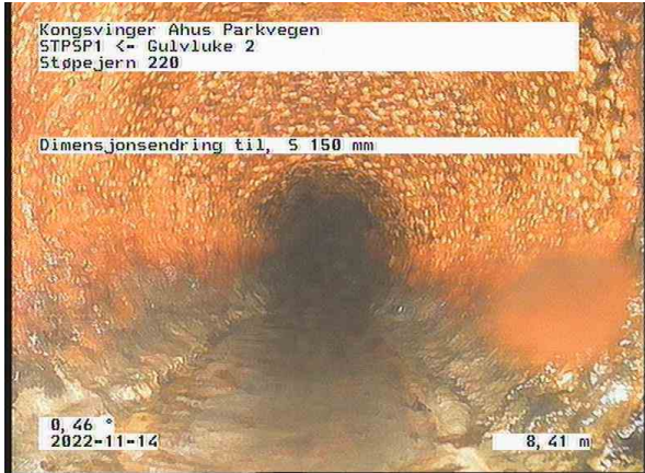
SP Bunnledning 3_DE 1_Gulvluke 2_14112022_095021_028.jpg, 00:02:11, 8.41m Dimensjonsendring til, S 150 mm
