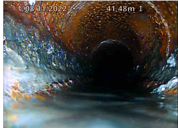
SP Bunnledning 2_Gulvluke 3_DE 1_08112022_071922_022.jpg, 00:07:27, 41.48m Tilkobling. Prefabrikkert grenrør på 2 Kl. / TKP 49
