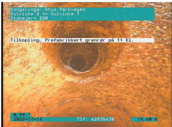
SP Bunnledning 4_Gulvluke 2_Gulvluke 1_14112022_084127_043.jpg, 00:06:22, 19.60m Tilkobling. Prefabrikkert grennrør på 11 Kl. / Ikke funnet tilhørighet
