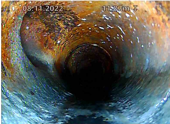
SP Bunnledning 2_Gulvluke 3_DE 1_08112022_071922_013.jpg, 00:02:11, 11.87m Tilkobling. Prefabrikkert grenrør på 10 Kl. / TKP 13
