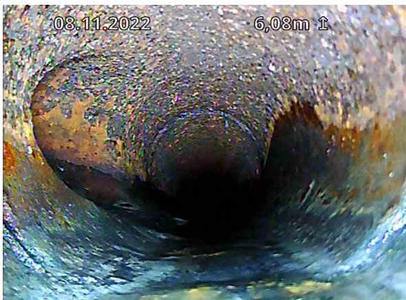
SP Bunnledning 2_Gulvluke 3_DE 1_08112022_071922_011.jpg, 00:01:12, 6.08m Tilkobling. Prefabrikkert grenrør på 10 Kl. / TKP 12
