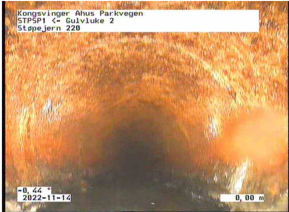
SP Bunnledning 3_DE 1_Gulvluke 2_14112022_095021_024.jpg, 00:00:03, 0.10m Korrosjon/Slitasje 3 av 12 Kl. til 12 Kl., Start, I stål- / støpejernsrør er det kraftig rustangrep
