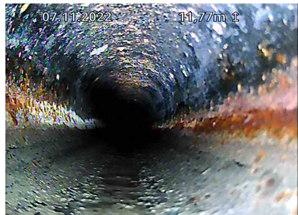
SP Bunnledning 1_TKP1_Gulvluke 3_07112022_094836_004.jpg, 00:03:19, 11.77m Korrosjon/Slitasje 2, I stål- / støpejernsrør et det begynnende rustangrep av 12 Kl. til 12 Kl., Start
