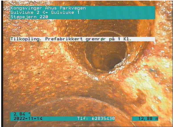
SP Bunnledning 4_Gulvluke 2_Gulvluke 1_14112022_084127_037.jpg, 00:04:10, 12.88m Tilkobling. Prefabrikkert grenrør på 1 Kl. / Ikke funnet tilhørighet
