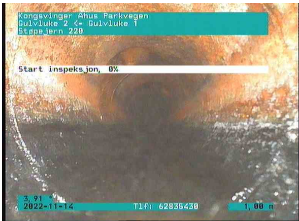
SP Bunnledning 4_Gulvluke 2_Gulvluke 1_14112022_084127_029.jpg, 00:00:02, 1.00m Korrosjon/Slitasje 2, i stål- / støpejernsrør et det begynnende rustangrep av 12 Kl. til 12 Kl., Start
