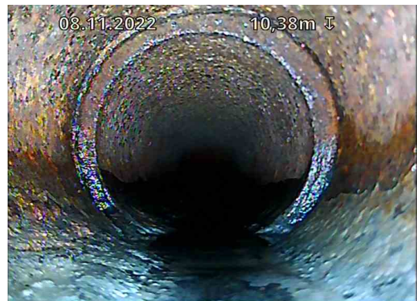
SP Bunnledning 2_Gulvluke 3_DE 1_08112022_071922_012.jpg, 00:01:53, 10.38m 2, Lengdeforskyvning (stive rør), Lengdeforskjøvet , / Anslått, kan også være en dimesjonsendring?
