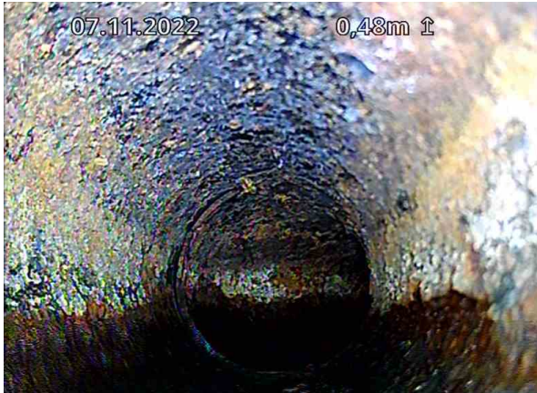
SP Bunnledning 1_TKP1_Gulvluke 3_07112022_094836_001.jpg, 00:00:28, 0.10m Korrosjon/Slitasje 3 av 12 Kl. til 12 Kl., Start, I stål- / støpejernsrør er det kraftig rustangrep
