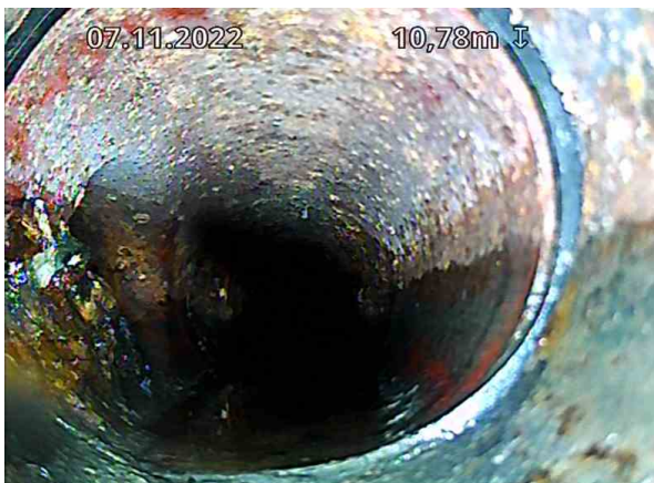
SP Bunnledning 1_TKP1_Gulvluke 3_07112022_094836_003.jpg, 00:02:50, 10.78m Tilkobling. Prefabrikkert grenrør på 10 Kl. / TKP 7
