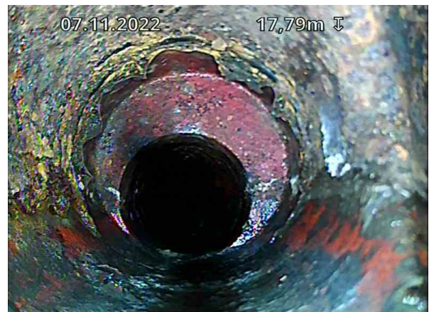
SP Bunnledning 1_TKP1_Gulvluke 3_07112022_094836_008.jpg, 00:05:18, 17.79m Dimensjonsendring til, S 75 mm / Anslått
