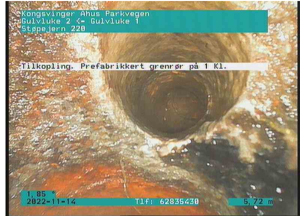
SP Bunnledning 4_Gulvluke 2_Gulvluke 1_14112022_084127_034.jpg, 00:02:01, 5.72m Tilkobling. Prefabrikkert grenrør på 1 Kl. / TKP 72, stamme i vegg uten tilkomst
