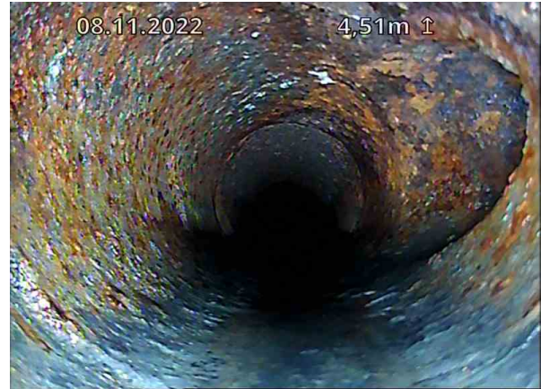
SP Bunnledning 2_Gulvluke 3_DE 1_08112022_071922_010.jpg, 00:00:55, 4.51m Tilkobling. Prefabrikkert grenrør på 2 Kl. / TKP 16
