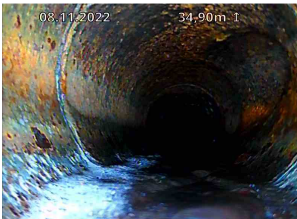
SP Bunnledning 2_Gulvluke 3_DE 1_08112022_071922_019.jpg, 00:05:50, 34.90m Tilkobling. Prefabrikkert grenrør på 2 Kl. / TKP 33
