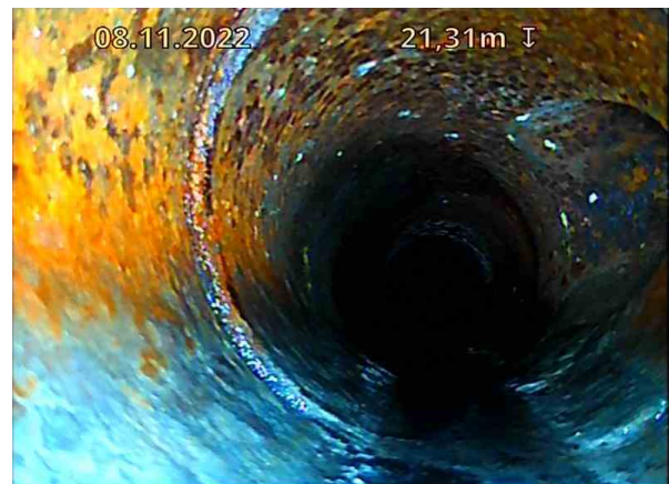
SP Bunnledning 2_Gulvluke 3_DE 1_08112022_071922_016.jpg, 00:03:45, 21.31m Tilkobling. Prefabrikkert grenrør på 2 Kl. / TKP 21
