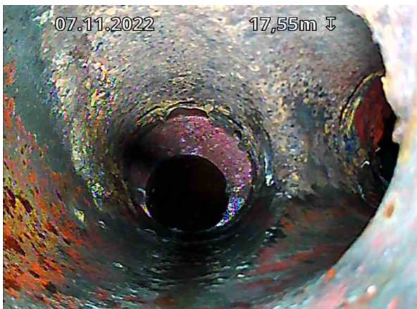
SP Bunnledning 1_TKP1_Gulvluke 3_07112022_094836_007.jpg, 00:05:01, 17.55m Tilkobling. Prefabrikkert grenrør på 3 Kl. / TKP 3
