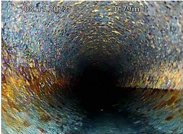
SP Bunnledning 2_Gulvluke 3_DE 1_08112022_071922_009.jpg, 00:00:20, 0.01m Korrosjon/Slitasje 2, 1 stål- / støpejernsrør et det begynnende rustangrep av 12 Kl. til 12 Kl., Start
