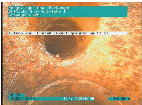
SP Bunnledning 4_Gulvluke 2_Gulvluke 1_14112022_084127_039.jpg, 00:04:52, 14.35m Tilkobling. Prefabrikkert grenrør på 11 Kl. / Ikke funnet tilhørighet
