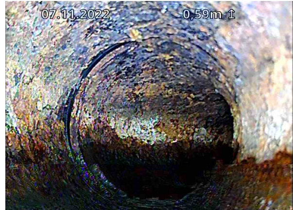
SP Bunnledning 1_TKP1_Gulvluke 3_07112022_094836_002.jpg, 00:00:54, 0.70m 2, Tverrforskyvning er mellom halve og hele rørveggtykkelsen (stive rør), Tverrforskjøvet på 9 Kl., / i skjøt før retningendring kl 3
