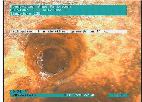
SP Bunnledning 4_Gulvluke 2_Gulvluke 1_14112022_084127_038.jpg, 00:04:25, 13.36m Tilkobling. Prefabrikkert grenrør på 1 Kl. / Ikke funnet tilhørighet
