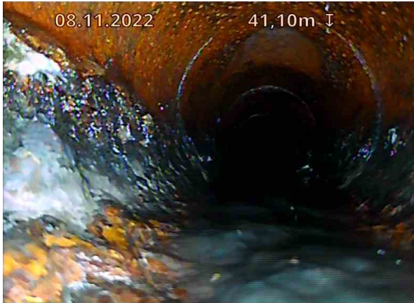
SP Bunnledning 2_Gulvluke 3_DE 1_08112022_071922_021.jpg, 00:07:15, 41.10m Tilkobling. Prefabrikkert grenrør på 12 Kl. / STPSP 2
