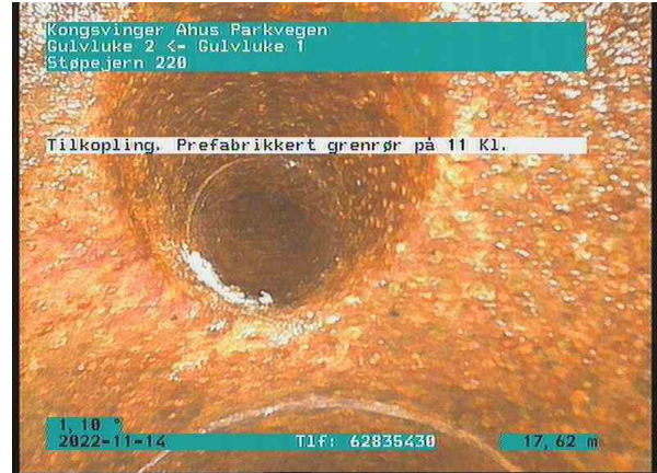
SP Bunnledning 4_Gulvluke 2_Gulvluke 1_14112022_084127_042.jpg, 00:05:55, 17.62m Tilkobling. Prefabrikkert grennrør på 11 Kl. / Ikke funnet tilhørighet
