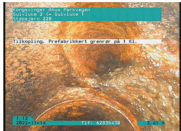
SP Bunnledning 4_Gulvluke 2_Gulvluke 1_14112022_084127_032.jpg, 00:00:59, 2.41m Tilkopling. Prefabrikkert grennrør på 1 Kl. / TKP 58
