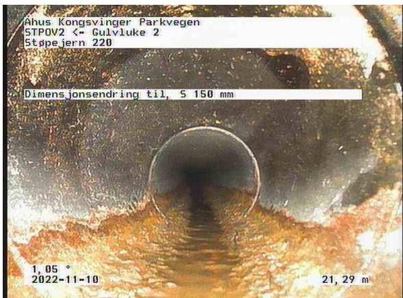
OV Bunnledning 4_DE2_Gulvluke 2_10112022_102637_020.jpg, 00:05:00, 21.29m Dimensjonsendring til, S 150 mm
