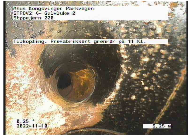
OV Bunnledning 4_DE2_Gulvluke 2_10112022_102637_015.jpg, 00:01:53, 5.25m Tilkobling. Prefabrikkert grenrør på 11 Kl. / Ikke bekreftet tilhørighet. Mistenker gammelt sluk?
