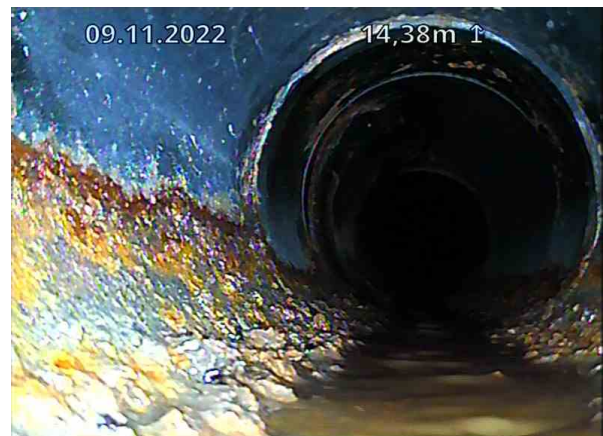
OV Bunnledning 3_STPOV1_DE2_09112022_080450_013.jpg, 00:02:51, 14.56m Dimensjonsendring til, S 225 mm
