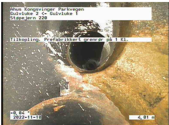
OV Bunnledning 5_Gulvluke 2_Gulvluke 1_10112022_101420_023.jpg, 00:01:03, 4.01m Tilkopling. Prefabrikkert grenrør på 1 Kl.
