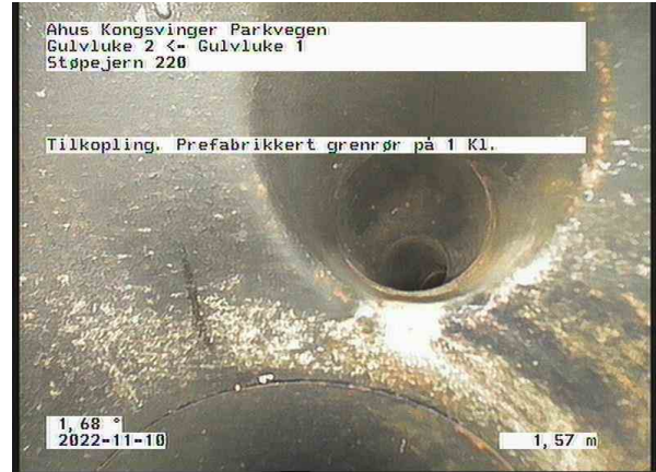
OV Bunnledning 5_Gulvluke 2_Gulvluke 1_10112022_101420_022.jpg, 00:00:30, 1.57m Tilkopling. Prefabrikkert grenrør på 1 Kl.
