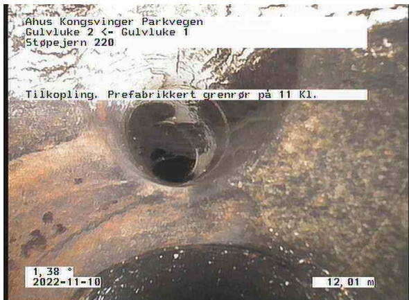
OV Bunnledning 5_Gulvluke 2_Gulvluke 1_10112022_101420_025.jpg, 00:03:05, 12.01m Tilkopling. Prefabrikkert grenør på 11 Kl. / Spindelvev, ikke i bruk?
