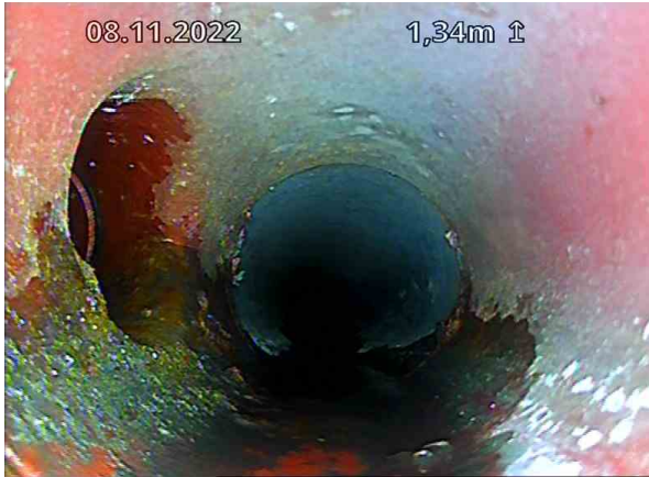
OV Bunnledning 1_TKP 4_Gulvluke 3_08112022_075042_001.jpg, 00:00:30, 1.34m Tilkobling. Prefabrikkert grenrør på 10 Kl. / TKP 8
