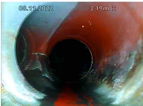
OV Bunnledning 1_TKP 4_Gulvluke 3_08112022_075042_003.jpg, 00:00:44, 3.19m Tilkobling. Prefabrikkert grenrør på 9 Kl. / TKP 10
