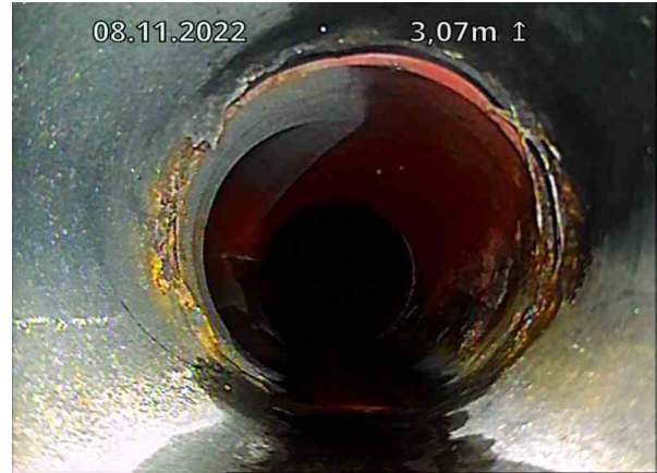
OV Bunnledning 1_TKP 4_Gulvluke 3_08112022_075042_002.jpg, 00:00:41, 3.07m Korrosjon/Slitasje 2, I stål- / støpejernsrør et det begynnende rustangrep av 12 Kl. til 12 Kl. / i skjøt
