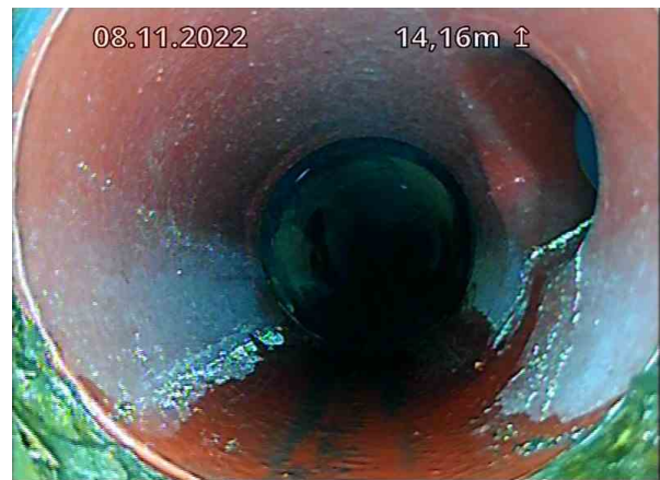
OV Bunnledning 1_TKP 4_Gulvluke 3_08112022_075042_004.jpg, 00:02:08, 14.16m Tilkobling. Prefabrikkert grenrør på 2 Kl. / TKP 2
