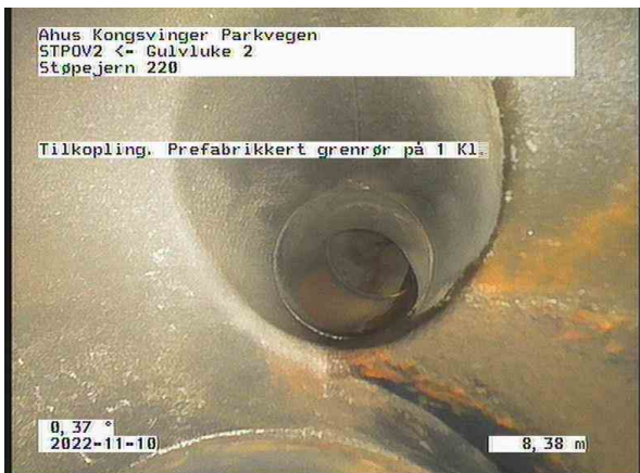
OV Bunnledning 4_DE2_Gulvluke 2_10112022_102637_016.jpg, 00:02:35, 8.38m Tilkopling. Prefabrikkert grenrør på 1 Kl. / TKP 53
