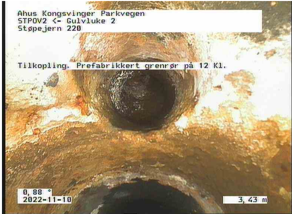
OV Bunnledning 4_DE2_Gulvluke 2_10112022_102637_014.jpg, 00:01:05, 3.42m Tilkopling. Prefabrikkert grenrør på 12 Kl. / TKP 71
