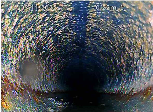
OV Bunnledning 2_Gulvluke 3_STPOV1_08112022_080106_005.jpg, 00:00:13, 0.01m Korrosjon/Slitasje 2, 1 stål- / støpejernsrør et det begynnende rustangrep av 12 Kl. til 12 Kl., Start
