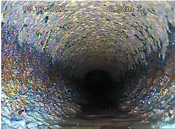
OV Bunnledning 3_STPOV1_DE2_09112022_080450_010.jpg, 00:00:39, 0.01m Korrosjon/Slitasje 2, I stål- / støpejernsrør et det begynnende rustangrep av 12 Kl. til 12 Kl., Start
