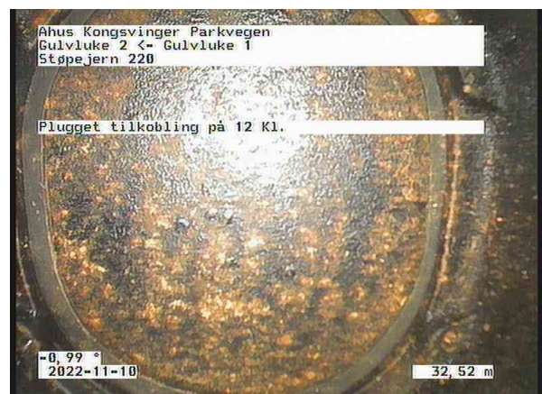
OV Bunnledning 5_Gulvluke 2_Gulvluke 1_10112022_101420_028.jpg, 00:06:40, 32.53m Plugget tilkobling på 12 Kl. / Gulvluke 2, luken er ikke synlig
