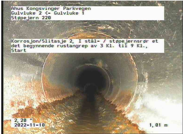
OV Bunnledning 5_Gulvluke 2_Gulvluke 1_10112022_101420_021.jpg, 00:00:06, 1.01m Korrosjon/Slitasje 2, I stål- / støpejernsrør et det begynnende rustangrep av 3 Kl. til 9 Kl., Start
