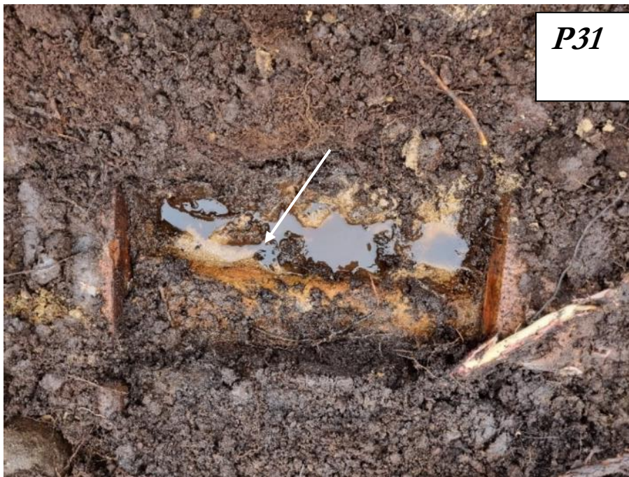
Figur 2-15. Fra prøvepunkt P31. Oljefylt kabel ligger blottlagt
