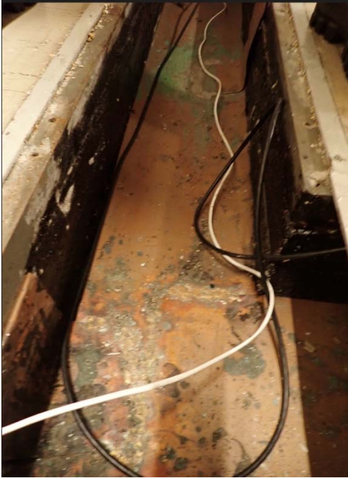
Figur 22 Svart maling/belegg på betongen i kabelkanalene i gulvet i elektronikkbygget.
