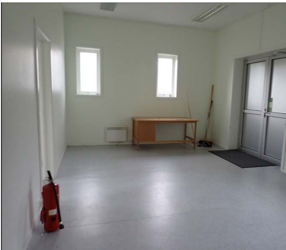
Figur 24 Nordøstre del av elektronikkbygget er oppusset i nyere tid, med vinylbelegg på gulvet.
