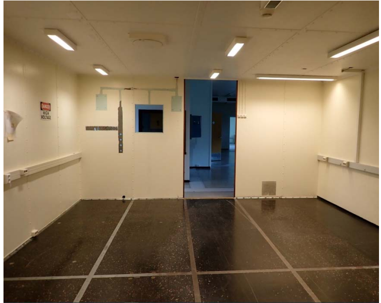
Figur 23 Datarom i elektronikkbygget.
