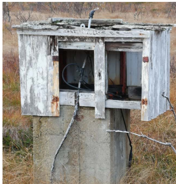
Figur 43 Betongfundament med elektriske koblinger/bokser.
