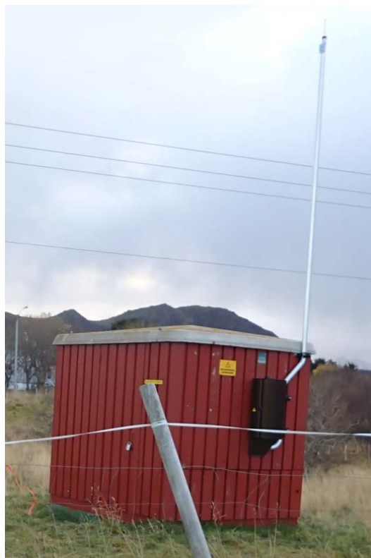
Figur 46 Trafostasjon. Denne er ikke kartlagt.
