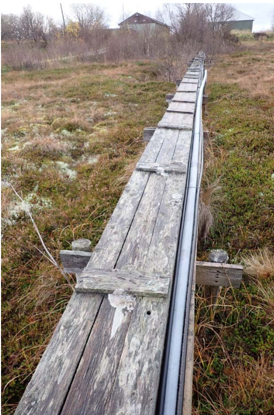
Figur 36 Kabelgate mellom Elektronikkbygg (bygningen øverst til høyre) og Senderbygget. Kabelgaten er vernet. Foto er tatt mot sørvest.
