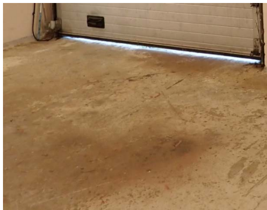
Figur 55 Prøve ble tatt av betongen under malingen i garasjen (prøve G5).
