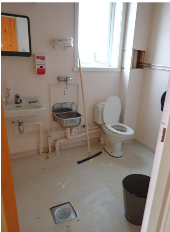
Figur 18 Toalett i elektronikkbygget.
