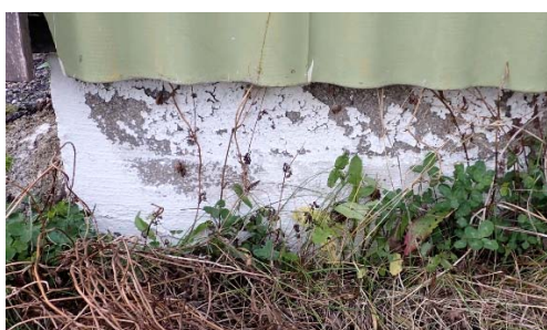
Figur 56 Prøve ble tatt av betongen bak malingen på garasjen (prøve G10).
