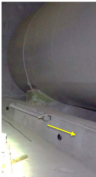
Figur 54 Betongfundament under tanker i tankbygg (prøve T3).
