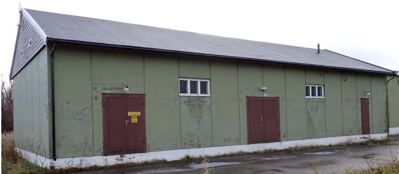
Figur 26 Nordvestre, og nordøstre fasade (med dører) på reservekraftbygget. Traforommet (innenfor døra med gult skilt) er ikke undersøkt. Øvrige deler av bygningen er kun delvis kartlagt.
