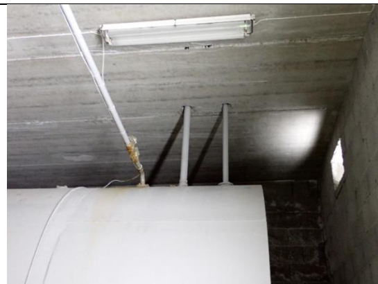
Figur 5 Rørføringer fra tank som går over tak.
