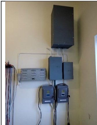
Figur 26 Strømskap som skal fjernes.
