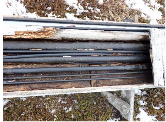
Figur 42 Kabler i kabelbru mellom Senderbygget og Elektronikkbygget – EE-avfall.
