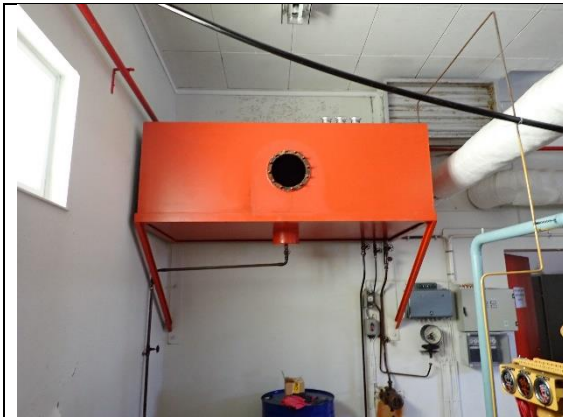
Figur 20 Dagtank som skal fjernes.
