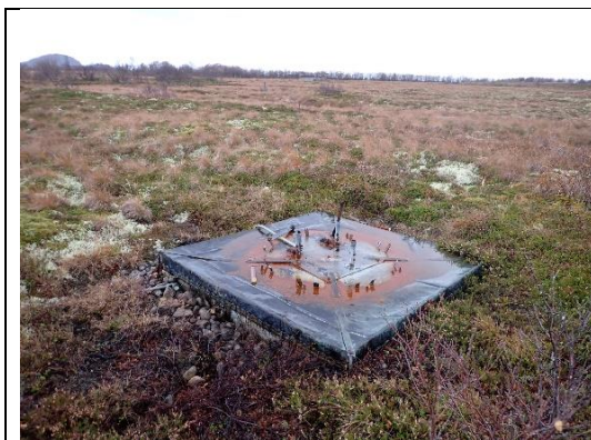
Figur 44 Betongfundament kledd med stålplate og oppstikkende skruer
