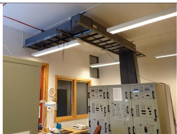
Figur 31 Kabelbru som er festet i himling. Himling er kledd med asbestholdige plater.
