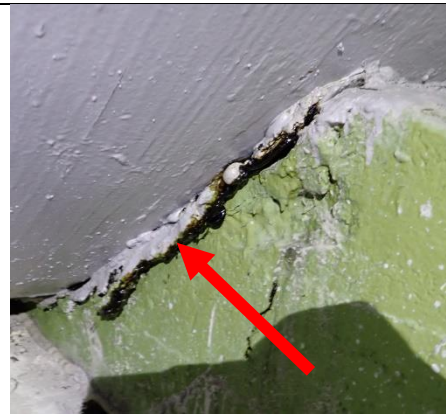
Figur 3 Asbestholdig fuger mellom tank og fundament.
