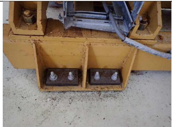
Figur 21 Innfesting i golv ifm. dieselaggregat.
