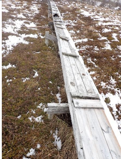
Figur 41 Kabelbru mellom Senderbygget og Elektronikkbygget – kreosotimpregnert trevirke.
