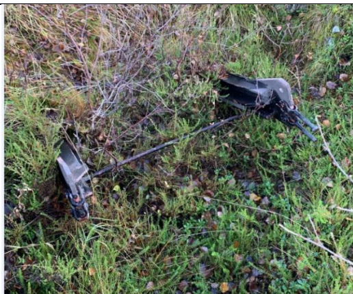
Figur 46 Festeanretninger – her ligger det sannsynligvis et betongfundament under.
