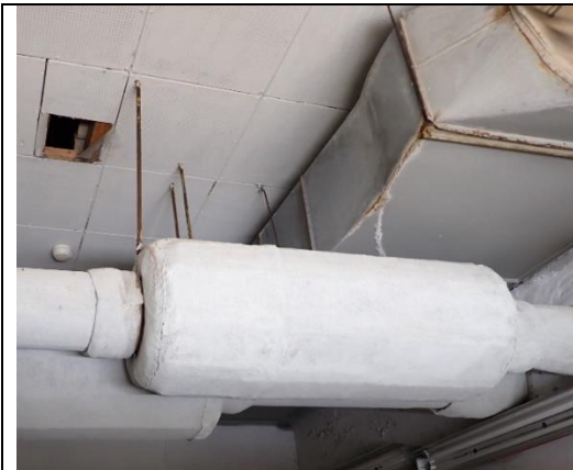
Figur 12 Oppheng av røykgassrør i himling. Himling er kledd med asbestholdige perforerte himlingsplater. Ventilasjonskanaler skal ikke fjernes.
