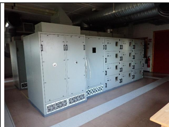
Figur 22 NATO utstyr som skal fjernes. Ventilasjonskanaler skal stå igjen og skal ikke berøres.
