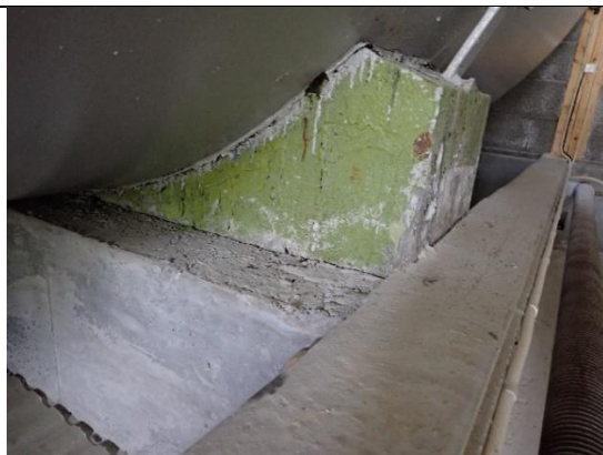
Figur 4 Grønnmaling som er farlig avfall med bly, på øvre del av fundament.
