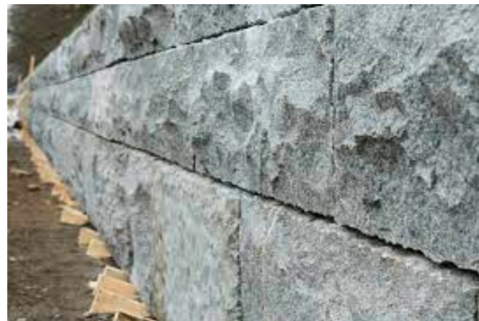
Tett kantstein mellom terreng og trekledning.
