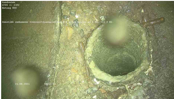
25547_4795_2352_Sandveien_210421_090945_078.jpg, 00:01:22, 18.30m Innstikk reduserer tverrsnittsarealet med 5 % eller mindre av 1 Kl. til 2 Kl.
