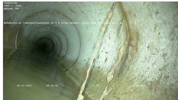
25605_2820_2819_Veumveien_010321_095355_029.jpg, 00:01:26, 11.30m Reduksjon av tverrsnittsarealet er 5 % eller mindre, enkle fine rottråder på 2 Kl.
