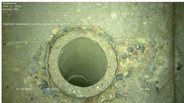
26064_5532_5531_Veumveien_210421_082545_072.jpg, 00:02:39, 38.40m Innstikk reduserer tverrsnittsarealet med 5 % eller mindre av 12 Kl. til 1 Kl.
