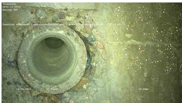
14_5531_5530_Veumveien_210421_075303_062.jpg, 00:02:08, 20.80m Innstikk reduserer tverrsnittsarealet med 5 % eller mindre av 10 Kl. til 11 Kl.
