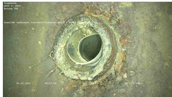
25605_2820_2819_Veumveien_010321_095355_031.jpg, 00:02:53, 29.10m Innstikk reduserer tverrsnittsarealet med 5 % eller mindre på 1 Kl.
