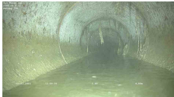
25607_2795_2131_Aas Wangs vei_010321_110810_047.jpg, 00:00:47, 4.80m Reduksjon av tverrsnittsarealet er 5 % eller mindre, enkle fine rottråder av 10 Kl. til 2 Kl.
