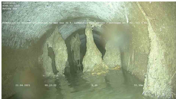
25547_4795_2352_Sandveien_210421_090945_082.jpg, 00:04:14, 55.30m Reduksjon av tverrsnittsarealet er mer enn 30 %, sammenfiltrede røtter / rottugge av 7 Kl. til 5 Kl.
