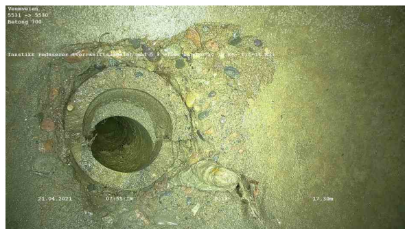
14_5531_5530_Veumveien_210421_075303_061.jpg, 00:01:42, 17.30m Innstikk reduserer tverrsnittsarealet med 5 % eller mindre av 10 Kl. til 11 Kl.
