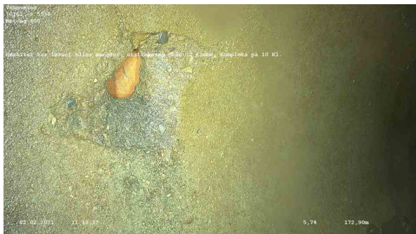
69818_70162_5536_Veumveien_020221_110309_018.jpg, 00:13:41, 172.90m Rørbitar har løsnet eller mangler, utstrekning under 2 timer, kompleks på 10 Kl.
