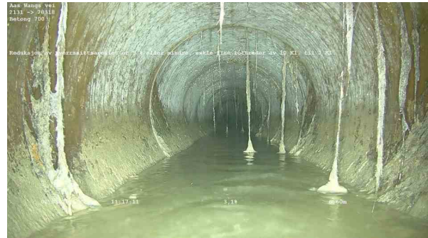
25609_2131_78318_Aas Wangs vei_010321_111533_051.jpg, 00:00:56, 6.60m Reduksjon av tverrsnittsarealet er 5 % eller mindre, enkle fine rottråder av 10 Kl. til 2 Kl.
