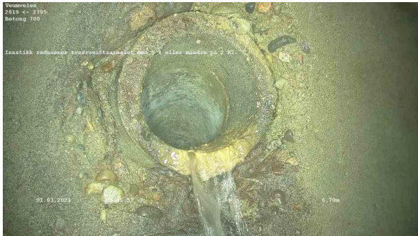
25606_2819_2795_Veumveien_010321_094413_021.jpg, 00:00:45, 6.70m Innstikk reduserer tverrsnittsarealet med 5 % eller mindre på 2 Kl.
