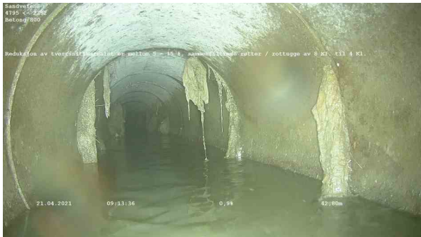
25547_4795_2352_Sandveien_210421_090945_080.jpg, 00:03:10, 42.80m Reduksjon av tverrsnittsarealet er mellom 5 - 15 %, sammenfiltrede røtter / rottugge av 8 Kl. til 4 Kl.
