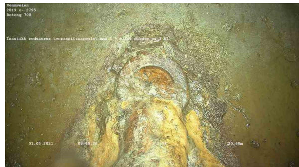
25606_2819_2795_Veumveien_010321_094413_024.jpg, 00:02:12, 20.60m Innstikk reduserer tverrsnittsarealet med 5 % eller mindre på 3 Kl.
