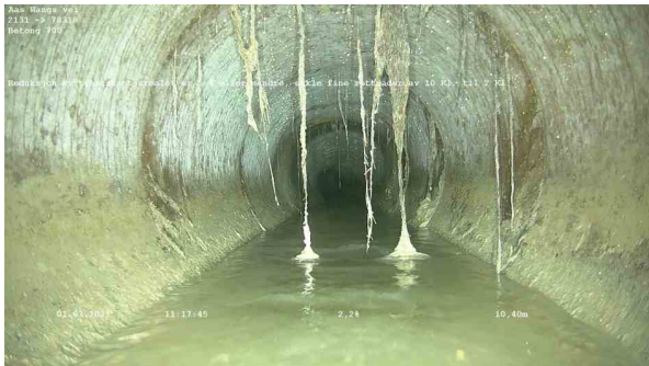
25609_2131_78318_Aas Wangs vei_010321_111533_052.jpg, 00:01:15, 10.40m Reduksjon av tverrsnittsarealet er 5 % eller mindre, enkle fine rottråder av 10 Kl. til 2 Kl.
