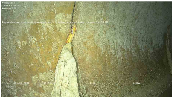
25605_2820_2819_Veumveien_010321_095355_028.jpg, 00:00:42, 6.90m Reduksjon av tverrsnittsarealet er 5 % eller mindre, tykk rotgren på 10 Kl.
