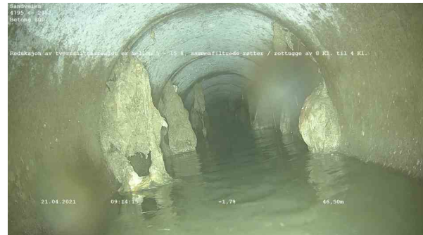
25547_4795_2352_Sandveien_210421_090945_081.jpg, 00:03:32, 46.50m Reduksjon av tverrsnittsarealet er mellom 5 - 15 %, sammenfiltrede røtter / rottugge av 8 Kl. til 4 Kl.
