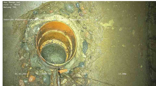
25609_2131_78318_Aas Wangs vei_010321_111533_053.jpg, 00:01:46, 13.80m Innstikk reduserer tverrsnittsarealet med 5 % eller mindre på 10 Kl.
