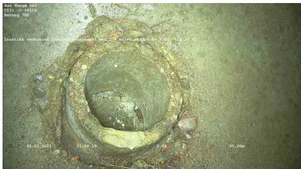
25609_2131_78318_Aas Wangs vei_010321_111533_056.jpg, 00:07:50, 95.00m Innstikk reduserer tverrsnittsarealet med 5 % eller mindre av 9 Kl. til 10 Kl.
