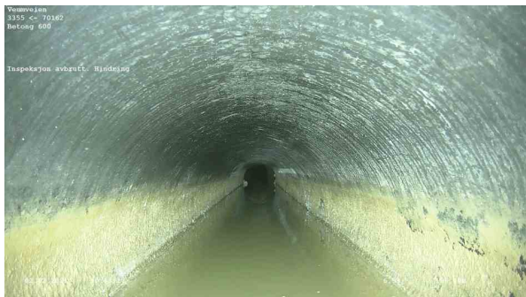
22641_3355_70162_Veumveien_020221_102428_015.jpg, 00:14:56, 196.80m Inspeksjon avbrutt. Hindring / Mindre dim.
