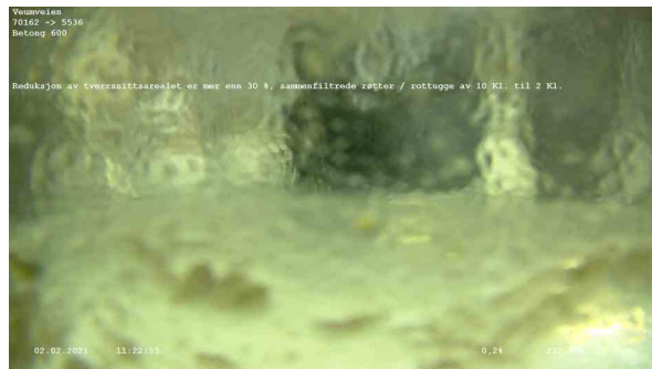
69818_70162_5536_Veumveien_020221_110309_019.jpg, 00:17:27, 212.90m Reduksjon av tverrsnittsarealet er mer enn 30 %, sammenfiltrede røtter / rottugge av 10 Kl. til 2 Kl.
