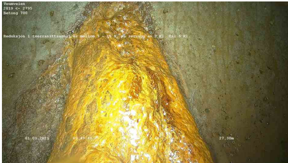
25606_2819_2795_Veumveien_010321_094413_025.jpg, 00:02:52, 27.30m Reduksjon i tverrsnittsareal er mellom 5 - 15 %, på rørvegg av 2 Kl. til 6 Kl.
