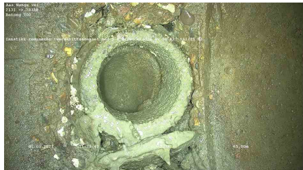
25609_2131_78318_Aas Wangs vei_010321_111533_055.jpg, 00:05:34, 65.00m Innstikk reduserer tverrsnittsarealet med 5 % eller mindre av 10 Kl. til 11 Kl.
