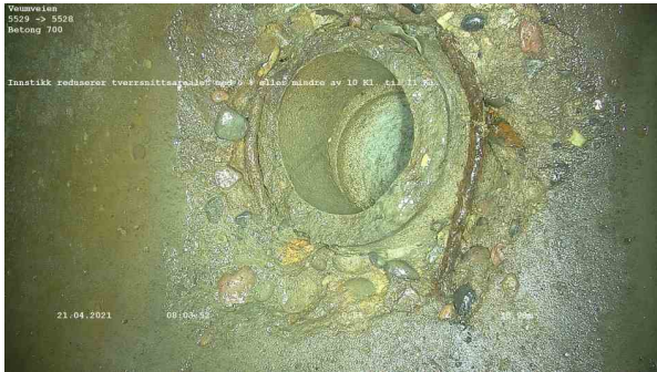
26067_5529_5528_Veumveien_210421_080230_066.jpg, 00:01:18, 18.90m Innstikk reduserer tverrsnittsarealet med 5 % eller mindre av 10 Kl. til 11 Kl.
