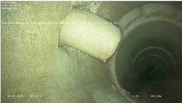
22641_3355_70162_Brønnerød_020221_090048_002.jpg, 00:14:03, 183.50m Innstikk reduserer tverrsnittsarealet med mellom 5 – 15% av 10 Kl. til 11 Kl.
