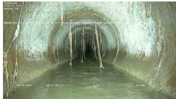
26064_5532_5531_Veumveien_210421_082545_071.jpg, 00:01:39, 25.60m Reduksjon av tverrsnittsarealet er 5 % eller mindre, sammenfiltrede røtter / rottugge av 9 Kl. til 3 Kl.
