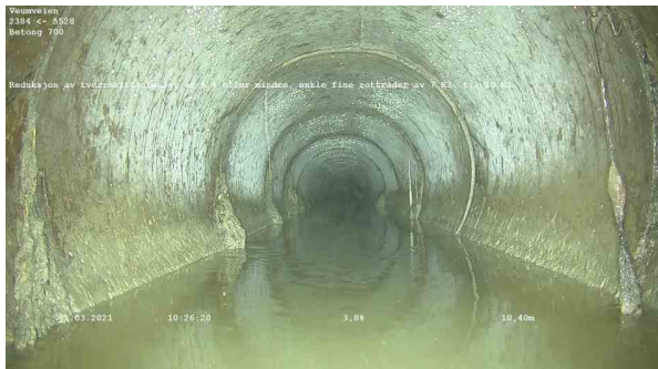
25523_2384_5528_Veumveien_010321_102505_044.jpg, 00:01:03, 10.40m Reduksjon av tverrsnittets areal er 5 % eller mindre, enkelte fine rottråder av 7 Kl. til 10 Kl.
