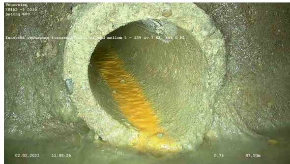
69818_70162_5536_Veumveien_020221_110309_017.jpg, 00:04:29, 47.50m Innstikk reduserer tverrsnittsarealet med mellom 5 - 15% av 7 Kl. til 8 Kl.
