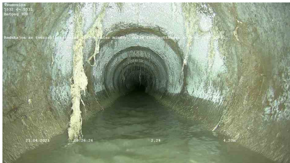
26064_5532_5531_Veumveien_210421_082545_070.jpg, 00:00:29, 4.20m Reduksjon av tverrsnittsarealet er 5 % eller mindre, enkle fine rottråder av 9 Kl. til 12 Kl.
