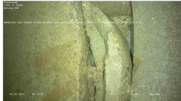
22641_3355_70162_Brønnerød_020221_090048_003.jpg, 00:14:51, 184.30m Rørbiter har løsnet eller mangler fra spissenden inne i muffen, tverrgående av 7 Kl. til 5 Kl.
