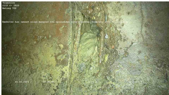
25602_2233_2820_Veumveien_010321_100105_033.jpg, 00:01:16, 17.60m Rørbiter har løsnet eller mangler fra spissenden inne i muffen, kompleks av 3 Kl. til 4 Kl.
