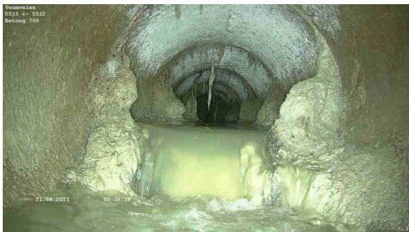
26063_5533_5532_Veumveien_210421_083358_077.jpg, 00:01:26, 6.30m Inspeksjon avbrutt. Hindring / Røtter
