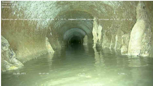
25523_5528_2384_Veumveien_210421_080651_068.jpg, 00:00:39, 6.70m Reduksjon av tverrsnittets areal er mellom 5 - 15 %, sammenfiltrede røtter / rottugge av 1 Kl. til 6 Kl.
