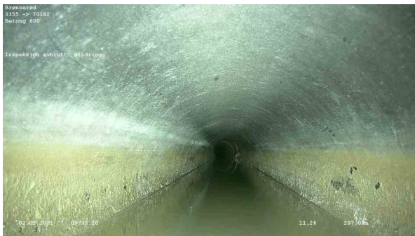
22641_3355_70162_Brønnerød_020221_090048_008.jpg, 00:26:35, 297.00m Inspeksjon avbrutt. Hindring / Mindre Dim.
