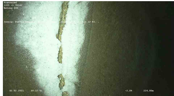
22641_3355_70162_Brønnerød_020221_090048_005.jpg, 00:18:29, 224.80m Innsig: Fuktig rørskjøt eller sprekk, i skjøt av 9 Kl. til 12 Kl. , / Is
