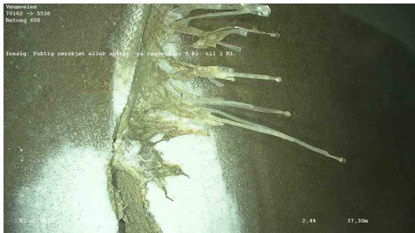
69818_70162_5536_Veumveien_020221_110309_016.jpg, 00:03:17, 37.30m Innsig: Fuktig rørsjøt eller sprekk, på rørvegg av 9 Kl. / 1s
