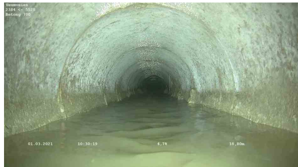
25523_2384_5528_Veumveien_010321_102505_045.jpg, 00:03:53, 18.80m Inspeksjon avbrutt. Hindring / Sten
