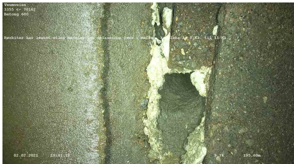
22641_3355_70162_Veumveien_020221_102428_013.jpg, 00:14:28, 195.60m Rørbiter har løstnet eller mangler fra spissenden inne i muffen, kompleks av 8 Kl. til 11 Kl.
