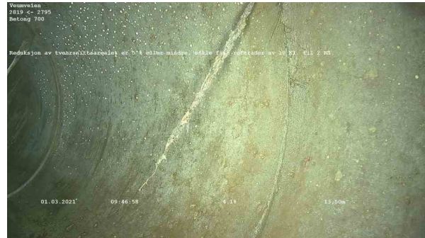
25606_2819_2795_Veumveien_010321_094413_022.jpg, 00:01:23, 13.50m Reduksjon av tverrsnittsarealet er 5 % eller mindre, enkelte fine rottråder av 10 Kl. til 2 Kl.
