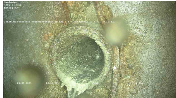
25547_4795_2352_Sandveien_210421_090945_079.jpg, 00:02:47, 41.00m Innstikk reduserer tverrsnittsarealet med 5 % eller mindre av 1 Kl. til 2 Kl.
