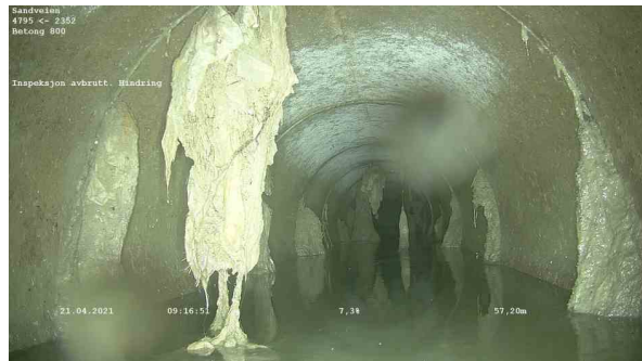
25547_4795_2352_Sandveien_210421_090945_083.jpg, 00:05:09, 57.20m Inspeksjon avbrutt. Hindring / Røtter
