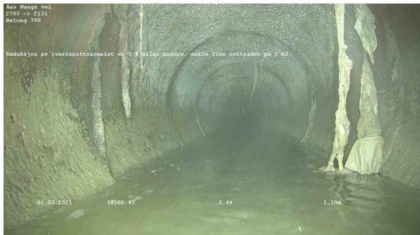
25607_2795_2131_Aas Wangs vei_010321_110810_046.jpg, 00:00:26, 1.10m Reduksjon av tverrsnittsarealet er 5 % eller mindre, enkle fine rottråder på 2 Kl.
