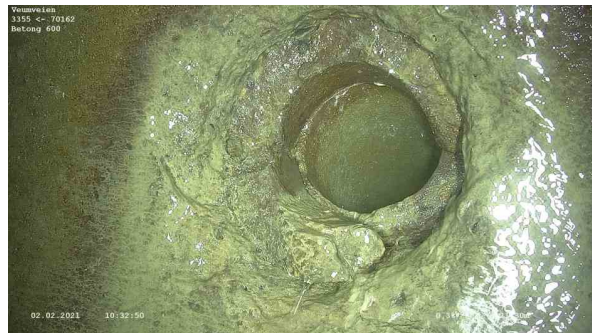
22641_3355_70162_Veumveien_020221_102428_010.jpg, 00:07:50, 121.30m Innstikk reduserer tverrsnittsarealet med 5 % eller mindre av 1 Kl. til 2 Kl.
