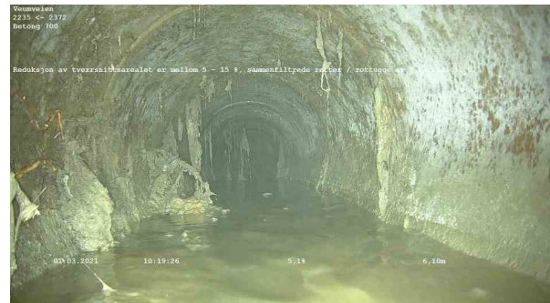
25589_2235_2372_Veumveien_010321_101747_040.jpg, 00:01:02, 6.10m Reduksjon av tverrsnittetsareale er mellom 5 - 15 %, sammenfiltrede røtter / rottugge av 7 Kl. til 12 Kl.
