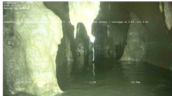
25837_2352_2282_Sandveien_210421_092847_085.jpg, 00:02:07, 26.00m Reduksjon av tverrsnittsarealet er mellom 5 - 15 %, sammenfiltrede røtter / rottugge av 8 Kl. til 4 Kl.
