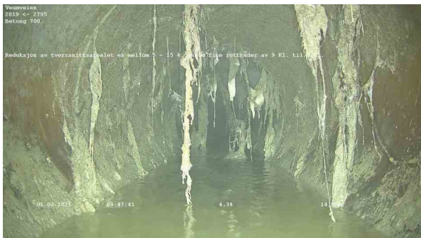
25606_2819_2795_Veumveien_010321_094413_023.jpg, 00:01:38, 14.90m Reduksjon av tverrsnittsarealet er mellom 5 - 15 %, enkelte fine rottråder av 9 Kl. til 3 Kl.
