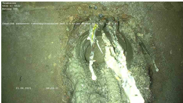
26063_5533_5532_Veumveien_210421_083358_075.jpg, 00:00:29, 0.70m Innstikk reduserer tverrsnittsarealet med 5 % eller mindre av 1 Kl. til 2 Kl.
