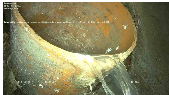
26064_5532_5531_Veumveien_210421_082545_073.jpg, 00:03:30, 49.30m Innstikk reduserer tverrsnittsarealet med mellom 5 – 15% av 8 Kl. til 10 Kl.
