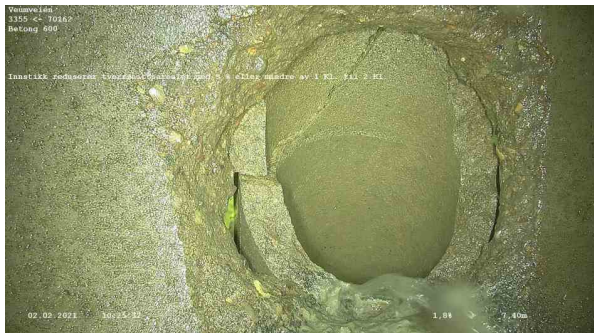
22641_3355_70162_Veumveien_020221_102428_009.jpg, 00:00:53, 7.40m Innstikk reduserer tverrsnittsarealet med 5 % eller mindre av 1 Kl. til 2 Kl.
