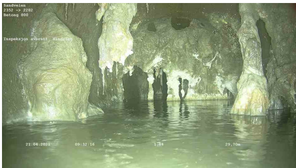
25837_2352_2282_Sandveien_210421_092847_086.jpg, 00:02:49, 29.70m Inspeksjon avbrutt. Hindring / Røtter
