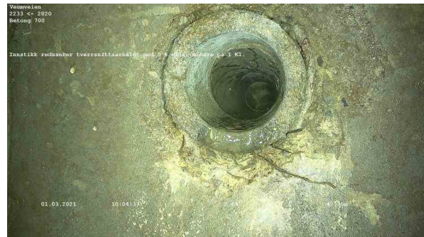
25602_2233_2820_Veumveien_010321_100105_034.jpg, 00:02:56, 42.30m Innstikk reduserer tverrsnittsarealet med 5 % eller mindre på 1 Kl.
