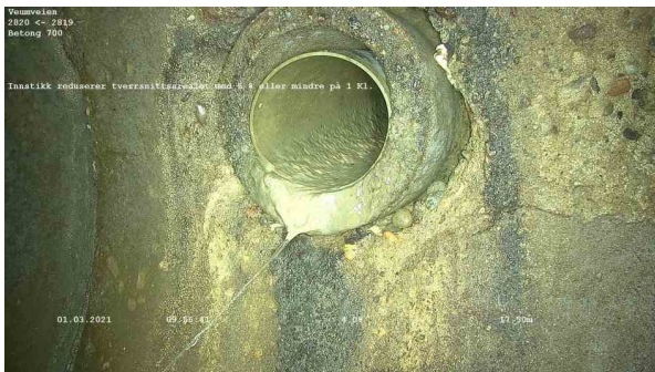
25605_2820_2819_Veumveien_010321_095355_030.jpg, 00:02:00, 17.50m Innstikk reduserer tverrsnittsarealet med 5 % eller mindre på 1 Kl.
