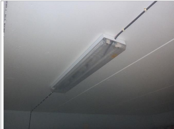
Bilde 24: Armatur med lysstoffrør
