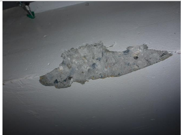
Bilde 16: Bygg 2 Betong i tak uten maling (prøvested B2-4)
