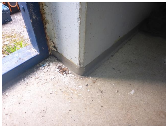
Bilde 20: Bygg 1 Vinyl vaskelist
