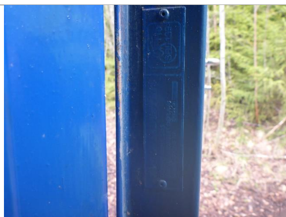
Bilde 8: Brannrører i Bygg 1 og 2 med overmalte etiketter bør inspiseres og behandles som mulig asbestholdig til inspeksjons avkrefter dette
