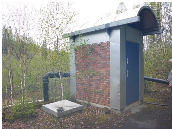
Bilde 2: Bygg 2 – Infiltrasjonsanlegg med brønner fra ca. 1986
