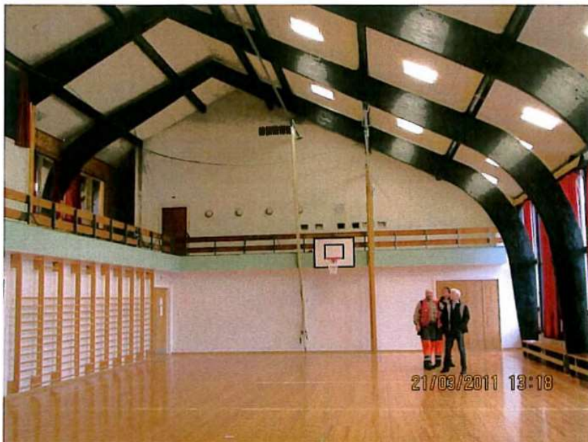
Foto 31: Gymsalen. Den fremstår i god stand. Tregolvet er godt vedlikeholdt. Under vinducene (til høyre) er det fuktslag i veggene, se neste foto.
