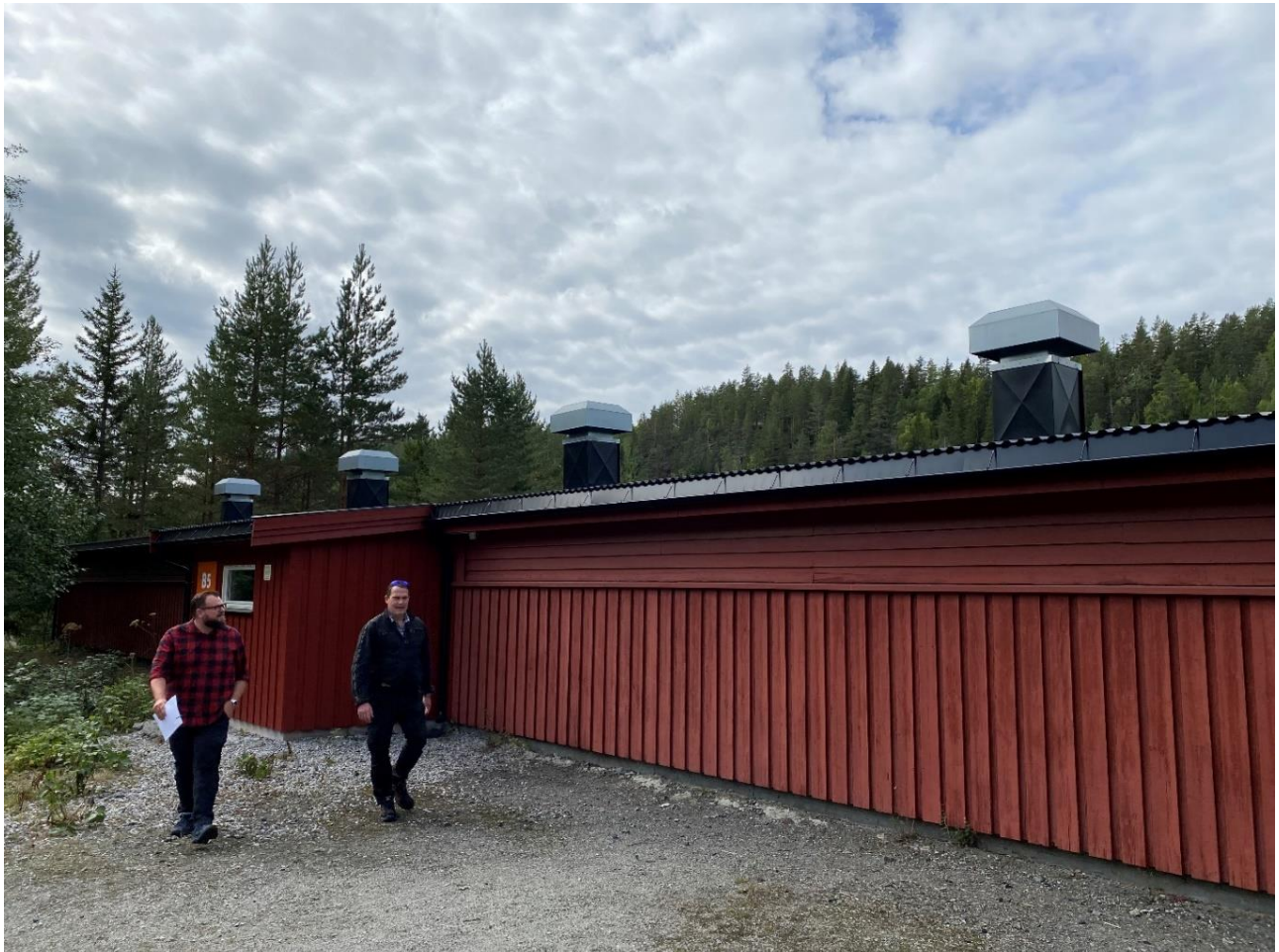
Tilluftsvifter plassert på tak
