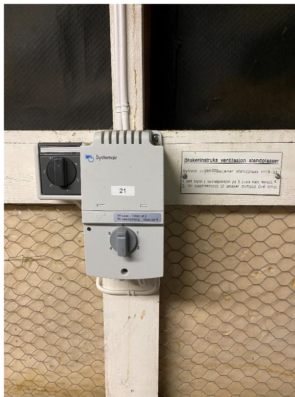
Trinnstyring av viftehastighet og timer for viftedrift.
