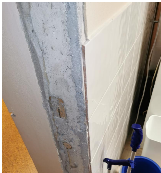
Bilde B2: Prøve nr. 2, flislim teknisk-/vaskerom
