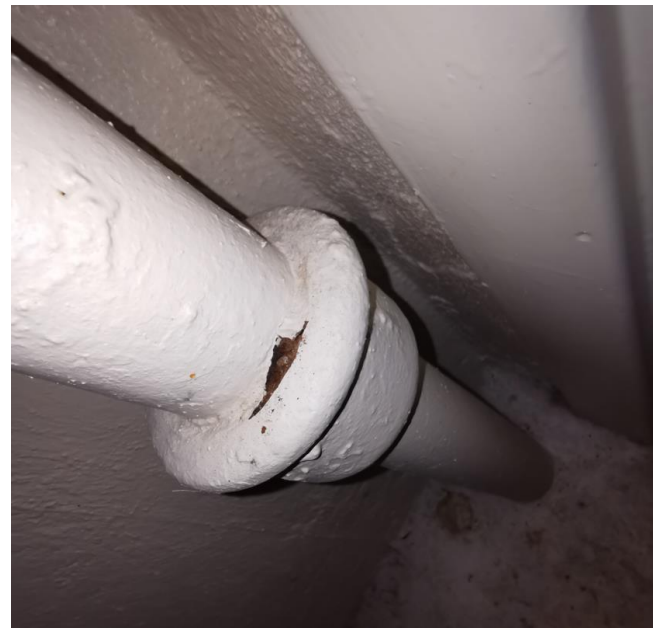
Bilde B8: Prøve nr. 8, fuge avløpsrør, bøttekott
