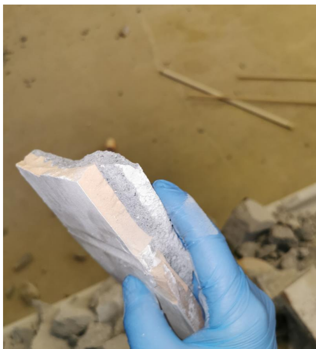
Bilde B3: Flis, fuge og lim, basseng
