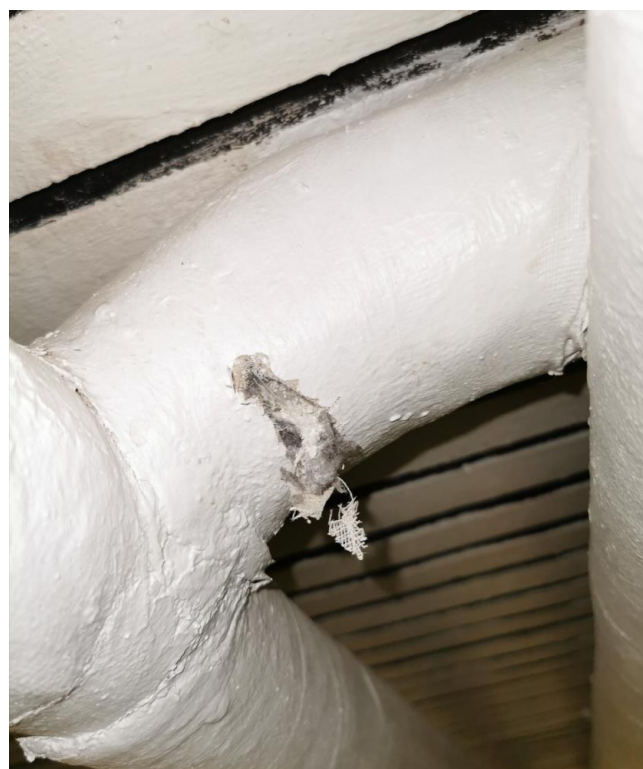
Bilde B12: Prøve nr. 12, rørisolasjon, bassengrom
