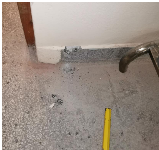
Bilde B4: Prøve nr. 4, oppkant terrazzo, bassengrom
