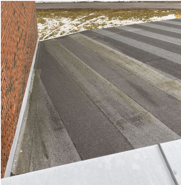
Figur 3 - Groe på østenden av taket som holdes avstand til
