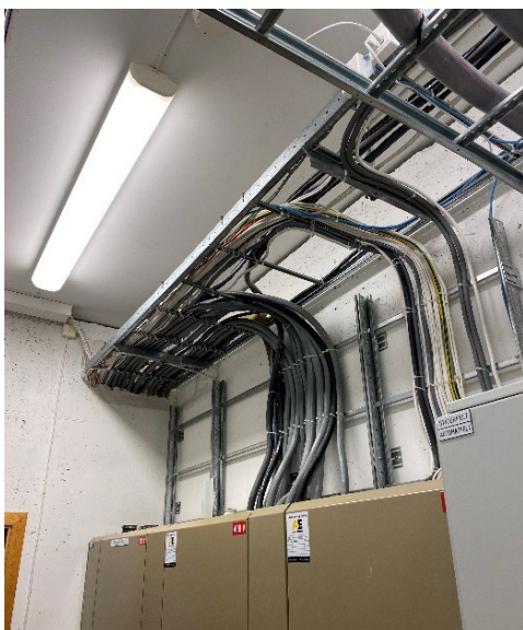
Figur 6 - Eksisterende hovedfordeling og føringsvei
