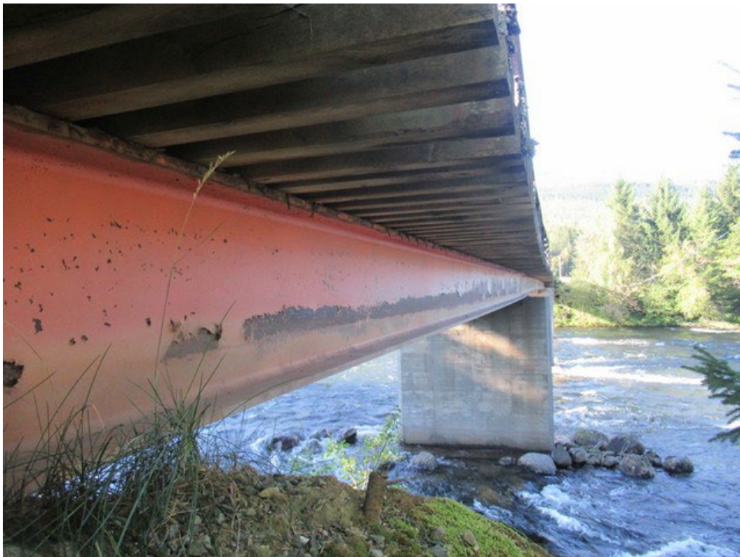
Bilde 8: Hovedbjelker, korrosjon og skader i overflatebehandling
