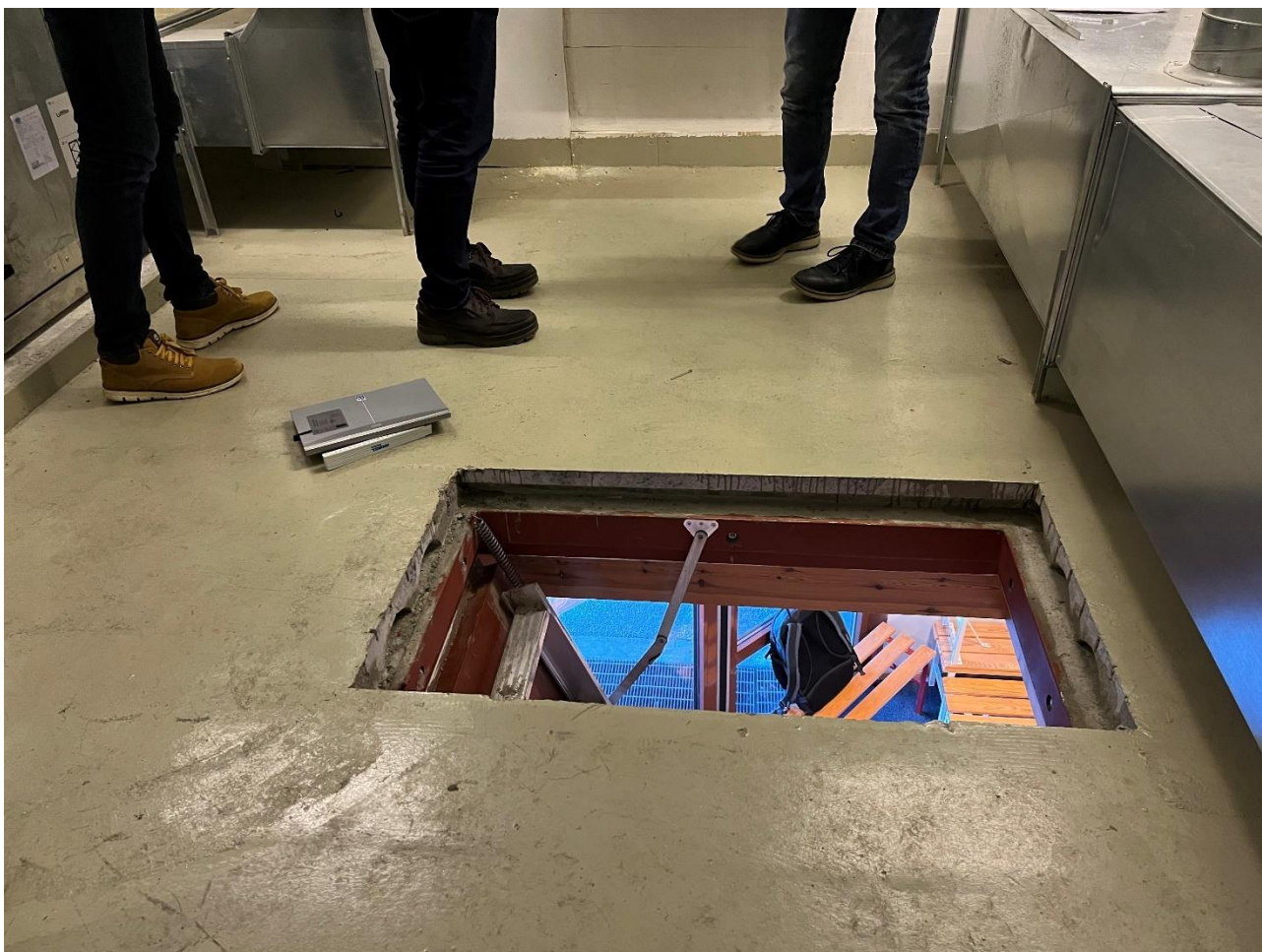
Figur 1 Ventilasjonsrom med usikret luke i gulv
