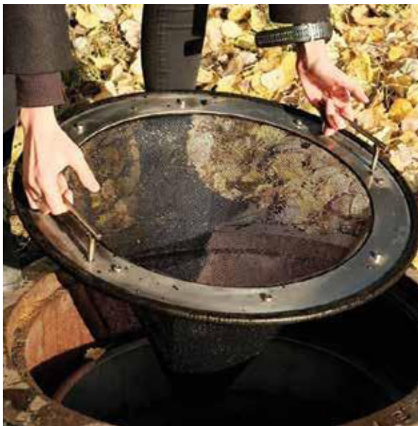
Granulatfangeren tas enkelt ut av kummen for rengjøring. Hvor ofte filteret må rengjøres, avhenger av kummens plassering. Foto: Miljøbaner
