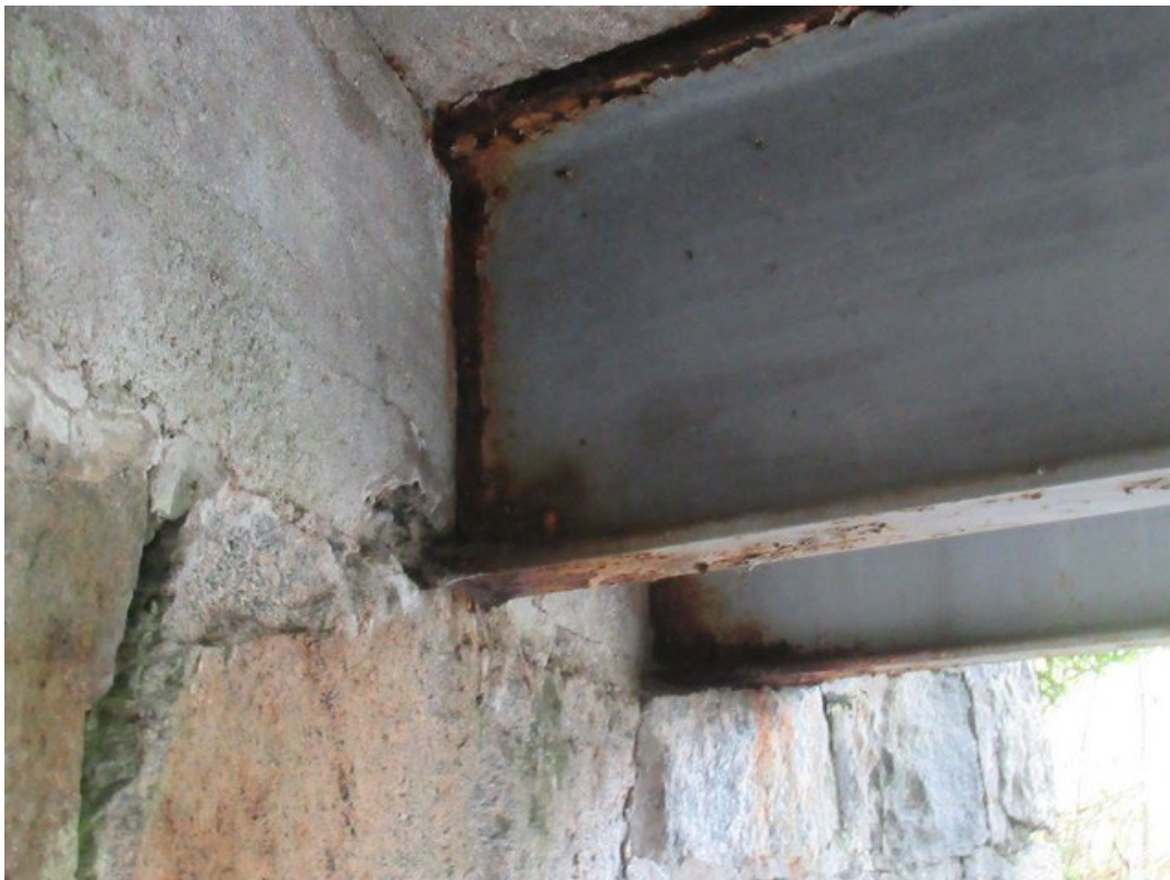
Bilde 8: Hovedbjelker, korrosjon i overflens og instøpningsoner
