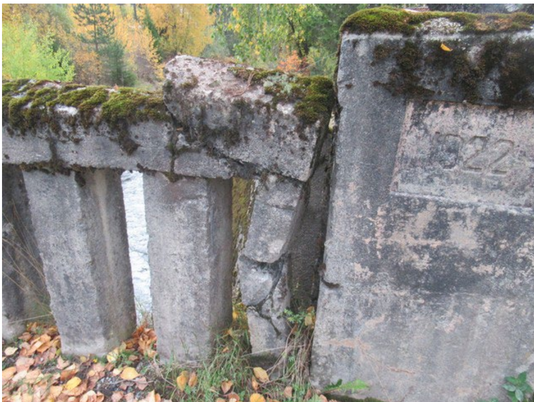
Bilde 12: Rekkverk – Brudd og skader i betong mange steder
