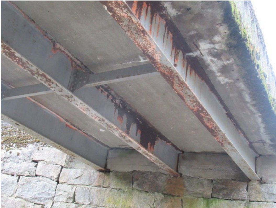
Bilde 7: Hovedbjelker, korrosjon
