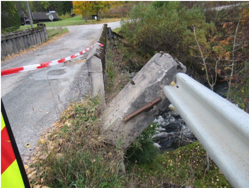
Bilde 11: Rekkverk – Brudd
