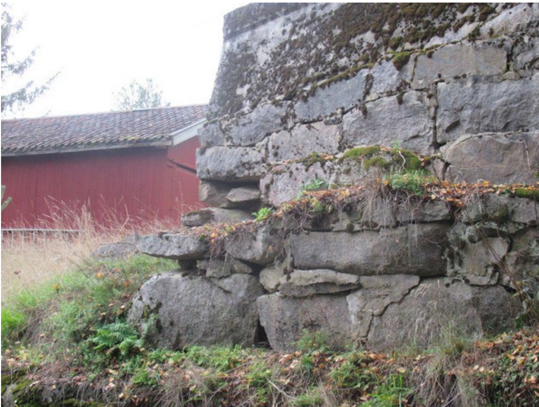
Bilde 4: Landkar vest – Noe utrasing ved kant vinge/støttemur
