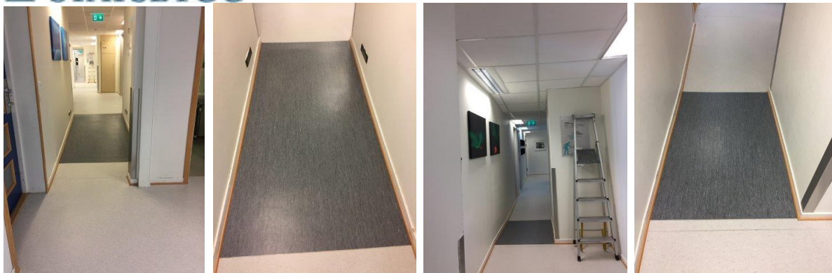
Foto viser nivåforskjell i korridor tatt ut med ramper i 3. etasje.
