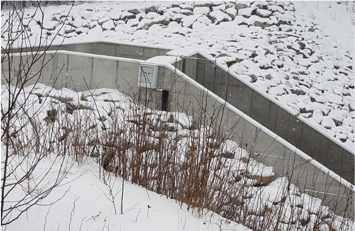
Figur 2.2: Eksisterende fordelingskap på bunnlastsperre/damkrone, sett fra fordeling ved Rondablikkvegen.
