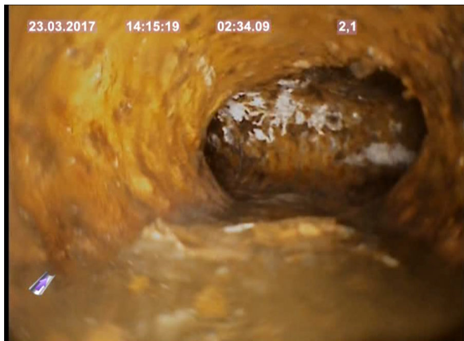
Foto: 2_SI_WorkNumber_S_Sectionname_Kum tilflukts romUt27032017141054_A.jpg 1,8m, Inspeksjon avbrutt Andre, i ved gren hovedrør
