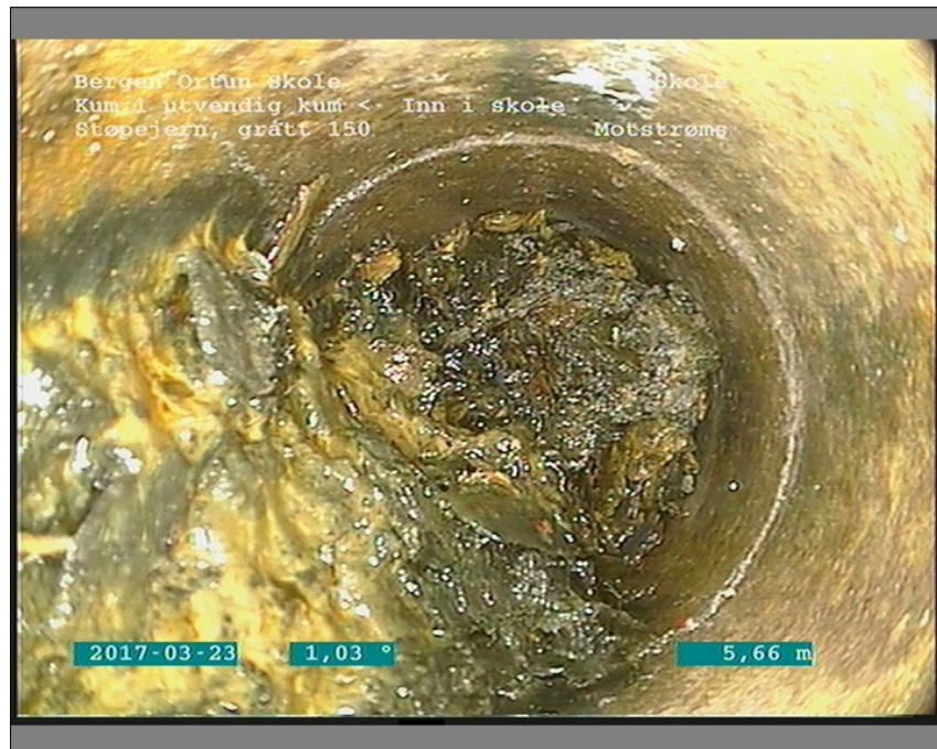
Foto: 1_SI_WorkNumber_S_Sectionname_Inn i skoleKum 1 utvendig kum23032017120920_A.JPG 5,65m, Tilkopling Prefabrikkert grennrør. 11 Kl., tett mulig plagget
