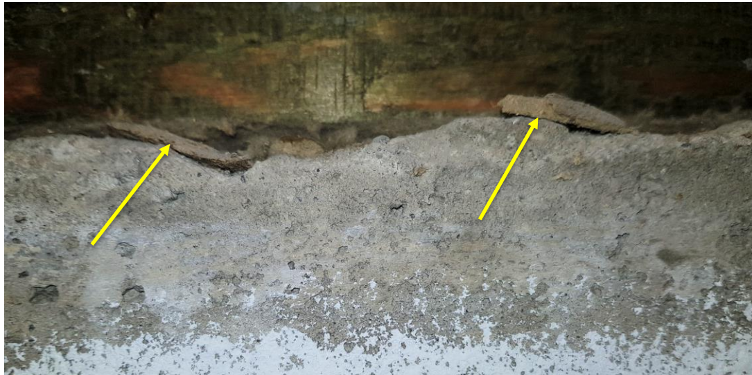
Figur 3: Løse biter av fugemasse med asbest (foto: NSS)
