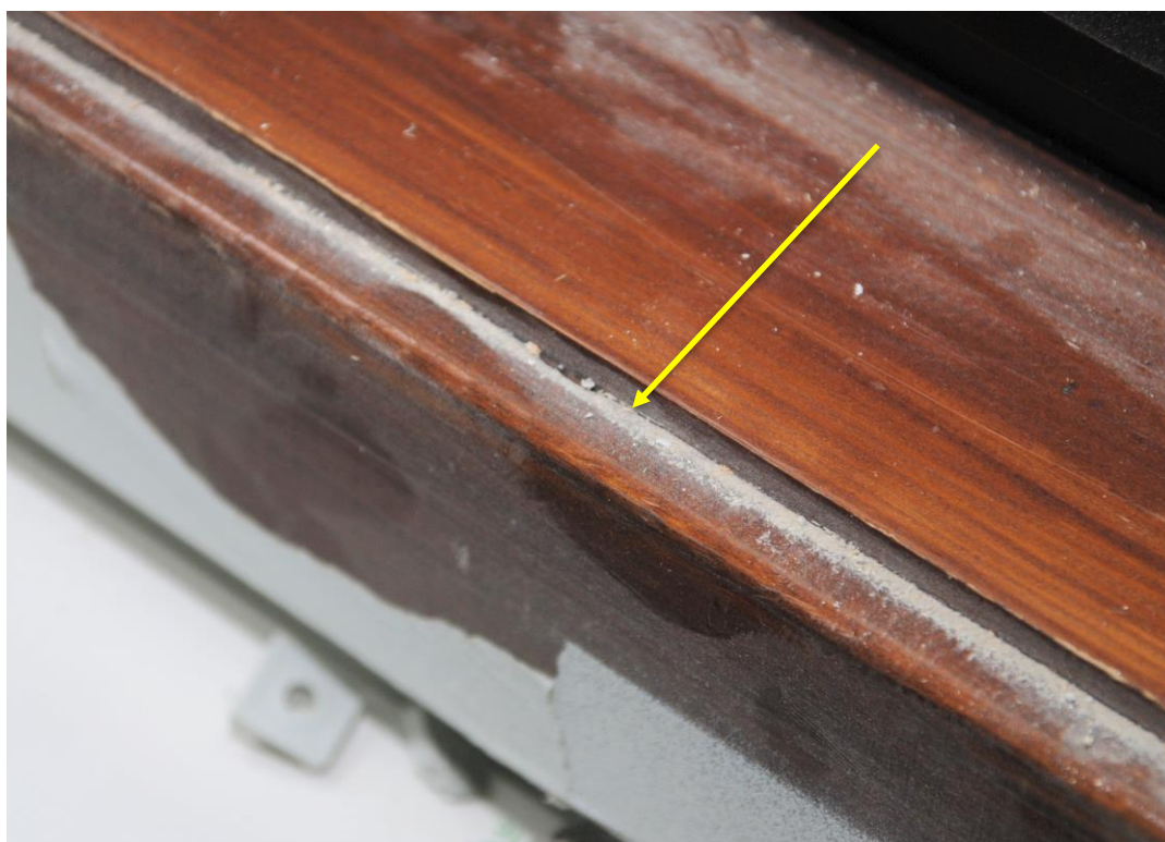
Figur 11: Her må det påføres fugemasse mellom vinduskarm og gerikt.
