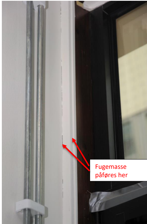
Figur 8: Eksempel på gerikt på side av vindu, med glipper.
