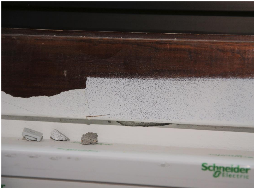
Figur 10: Illustrasjon som viser at det kun er 2 cm mellom kabelkanal og gerikt, og at murpuss har falt av.
