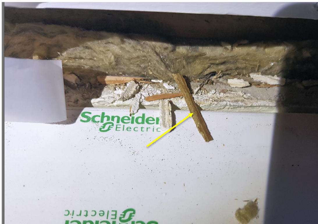
Figur 4: Løse biter av fugemasse med asbest (foto: NSS)
