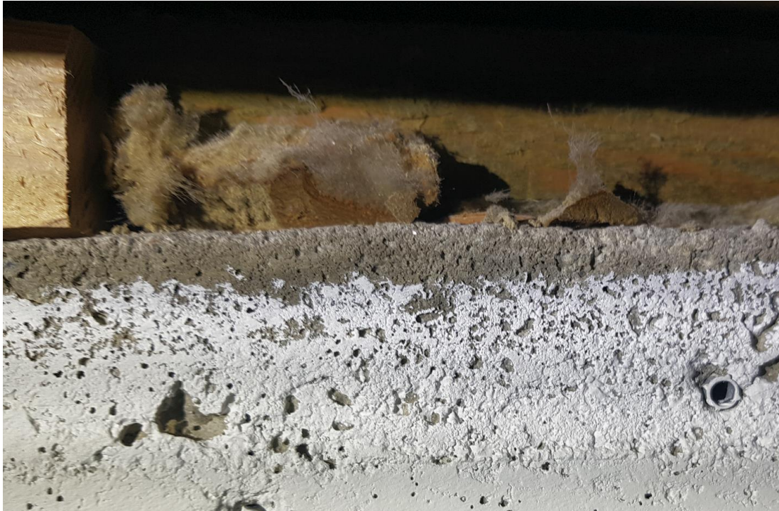
Figur 5: Løse biter av fugemasse med asbest (foto: NSS)
