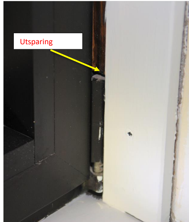
Figur 9: Bildet er litt mørkt, men det viser en utsparing i gerikt for å få plass til hengselet. Potensielt lekkasjepunkt for asbest.
