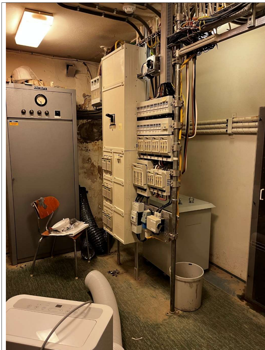
Hovedtavlerom vegg i vegg fyrrom.
