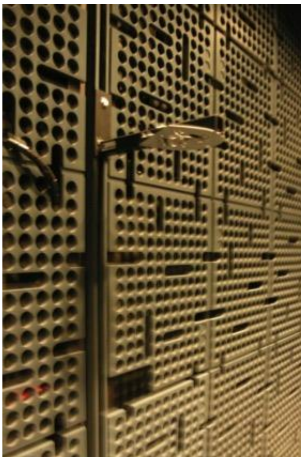
Vegg fra "Byteatret" i Helsinki, Finland. Perforerte og lakkerte MDF-plater mellom Unistrut-profilene.
