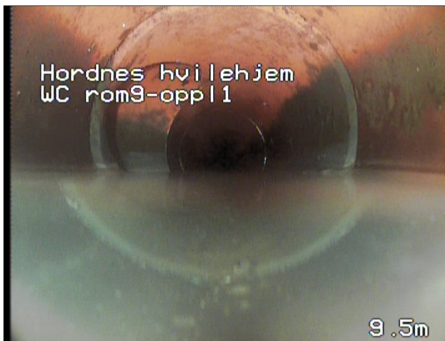
Foto: 000749__oppløp1_Wc 1etg rom 1_2105202121052021.jpg 9,5m, Vannivå 25%, Start
