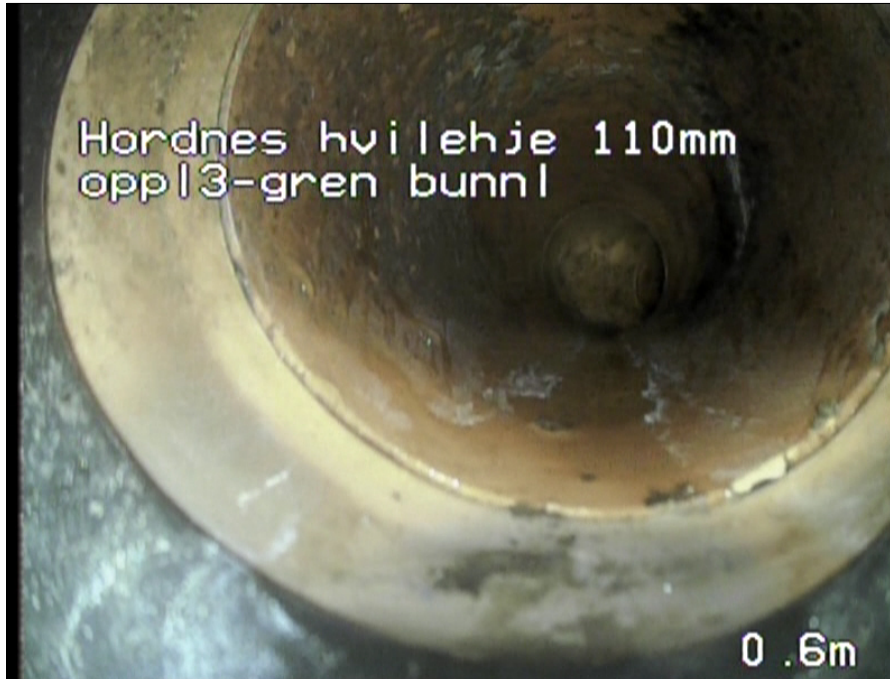
Foto: 000102__Gren bunnledning_Oppløp 3_2105202121052021.jpg 0,6m, Forskjøvet skjøt forskyvningen er mellom halve og hele rørtykkelsen, fra 12 til 12 Kl., Lengdeforskjøvet
