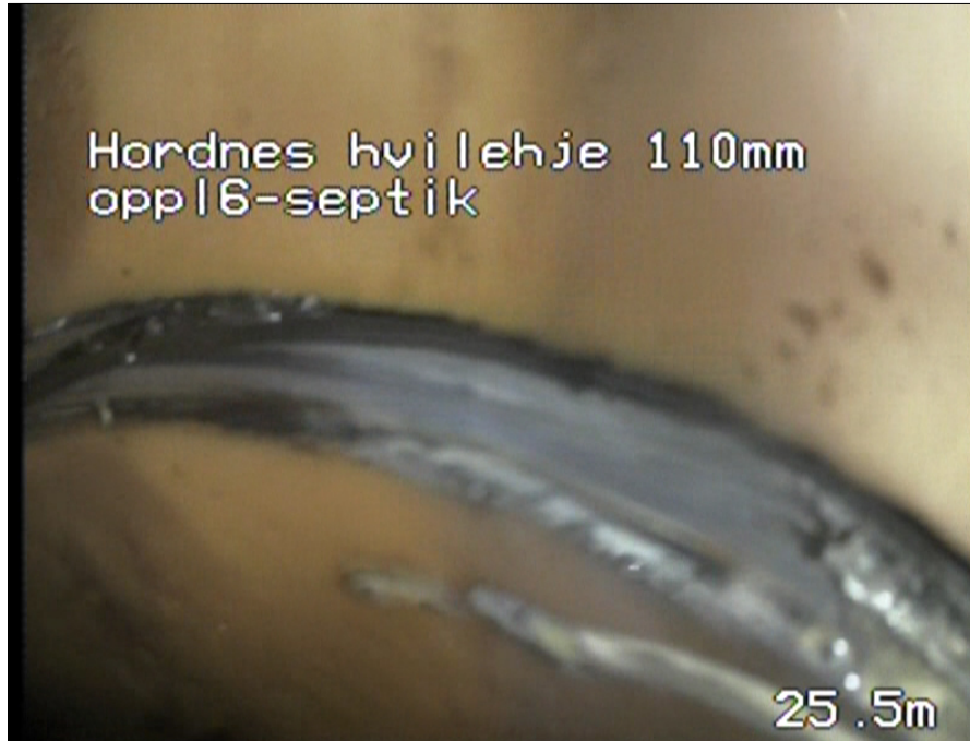
Foto: 000829__Septiktank_Oppløp 6_2105202121052021.jpg 25,5m, Sprukket rør, Rørbiter har løsnet eller mangler/teglstein mangler fra sin opprinnlige posisjon, fra 12 til 12 Kl., Kompleks, Sprukket i rør skjøt.
