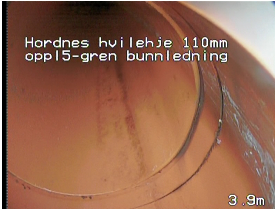
Foto: 000157__Gren bunnledning_Oppløp 5_2105202121052021.jpg 3,9m, Sprukket rør, sprekke er åpne/løse teglstein, fra 02 til 09 Kl., Komplex, Sprukket i gren
