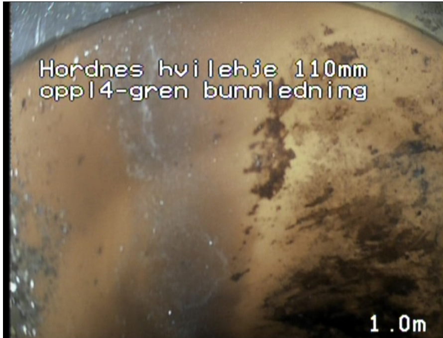
Foto: 000117__Gren bunnledning_Oppløp 4_2105202121052021.jpg 1m, Forskjøvet skjøt forskyvningen er mellom halve og hele rørtykkelsen, fra 12 til 12 Kl., Lengdeforsjøvet
