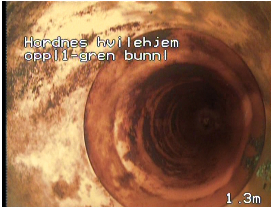
Foto: 000158__Gen bunnledning_oppløp 1_2105202121052021.jpg 1,4m, Forskjøvet skjøt forskyvningen er mellom halve og hele rørtykkelsen, fra 12 til 12 Kl., Lengdeforsjøvet
