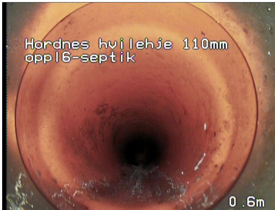
Foto: 000040__Septiktank_Oppløp 6_2105202121052021.jpg 0,6m, Forskjøvet skjøt forskyvningen er mellom halve og hele rørtykkelsen, fra 12 til 12 Kl., Lengdeforskjøvet
