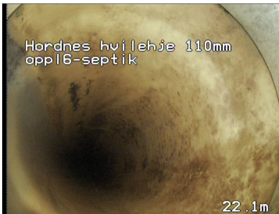
Foto: 000744__Septiktank_Oppløp 6_2105202121052021.jpg 22,2m, Forskjøvet skjøt forskyvningen er mellom halve og hele rørtykkelsen, fra 12 til 12 Kl., Lengdeforskjøvet
