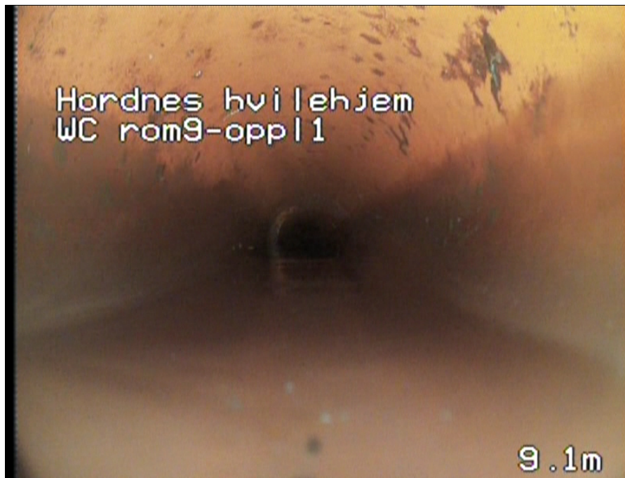
Foto: 000744__oppløp1_Wc 1etg rom 1_2105202121052021.jpg 9m, Vannivå 15%, Start
