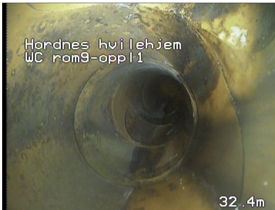
Foto: 001543__oppløp1_Wc 1etg rom 1_2105202121052021.jpg 32,4m, Sprukket rør, sprekene er åpne/løse teglstein, fra 02 til 08 Kl., Kompleks
