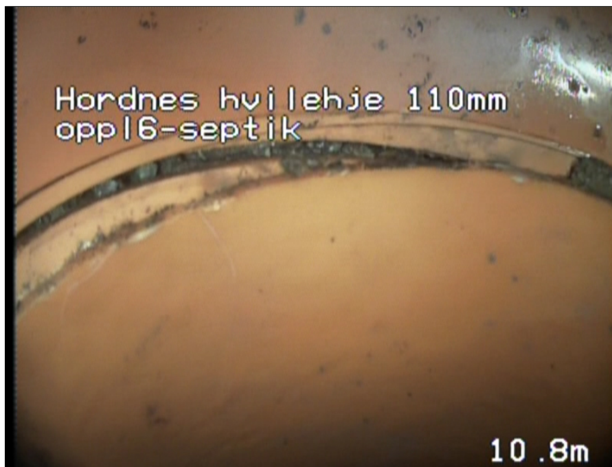
Foto: 000336__Septiktank_Oppløp 6_2105202121052021.jpg 10,8m, Sprukket rør, Rørbiter har løsnet eller mangler/teglstein mangler fra sin opprinnlige posisjon, fra 12 til 12 Kl., Kompleks, Sprukket i rør skjøt.
