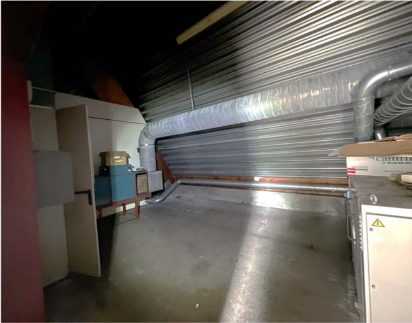
Figur 7: Innvendig i ventilasjonsrommet. Foto: Multiconsult.
