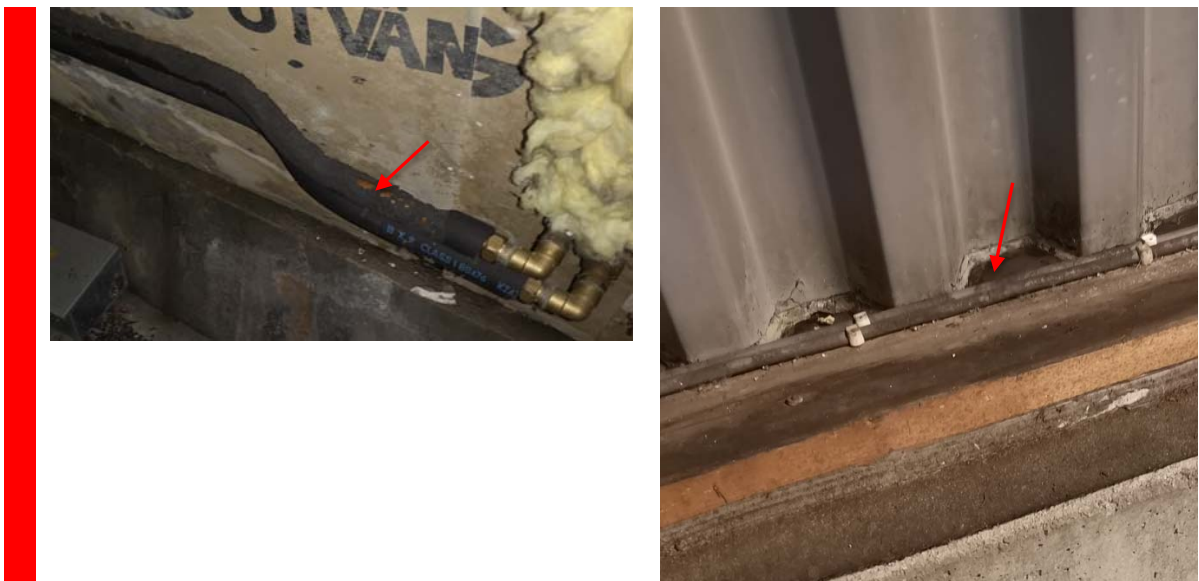
Figur 23: Cellegummi som isolasjon rundt rør (venstre bilde), og mellom stålplater i fasade og grunnmur (høyre bilde). Cellegummien inneholder bromerte flammehemmere over grensen for farlig avfall, og skal leveres til godkjent mottak for farlig avfall.
