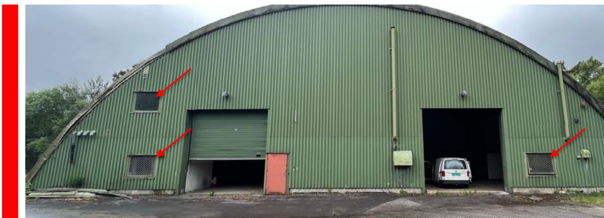
Figur 14: Isolerglassruter med innhold av klorparafiner. Foto: Multiconsult.
