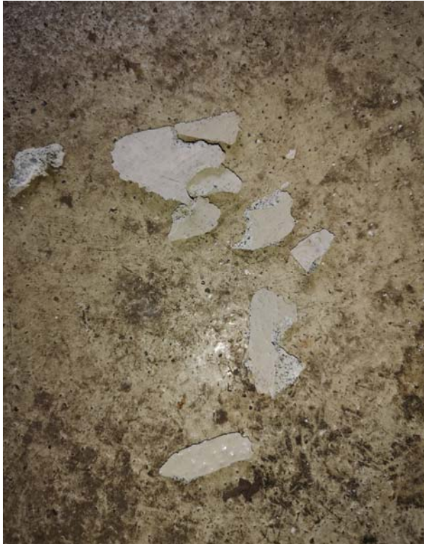
Figur 19: Epoxybelegg på gulv i verksted. Prøve P16 ble tatt av belegget. Det ble ikke påvist tungmetaller, PCB eller asbest som klassifiserer belegget som farlig avfall.
