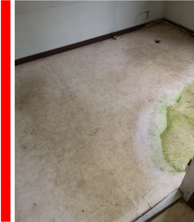
Figur 17: Vinylbelegg på gulv i første etasje i kontordel. Vinylbelegget inneholder erfaringsmessig ftalater over grensen for farlig avfall.
