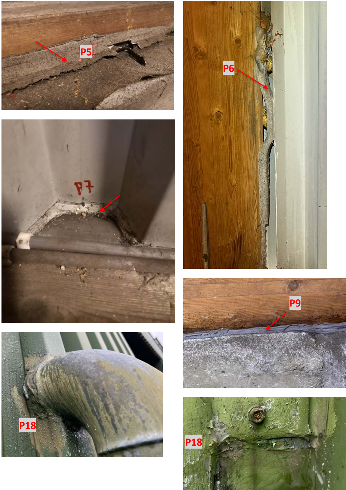
Figur 22: Fugemasser observert inni og på nordøstre fasade på lagerhallen. Det ble ikke påvist PCB i prøvene av fugemassene. All fugemasse som påtreffes under rivingen skal fjernes og leveres til godkjent mottak som organisk avfall med halogener.
