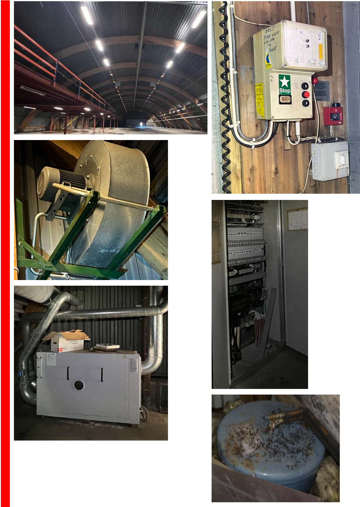
Figur 25: Eksempler på EE-avfall i bygningen.
