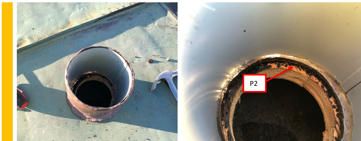
Figur 8 Takpapp (P2) under kobbertekking på tak over Store studio. Prøven inneholdt PAH under grenseverdi for farlig avfall.
