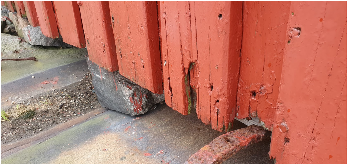
Det er en del skadet kledningsbord på veggen.
