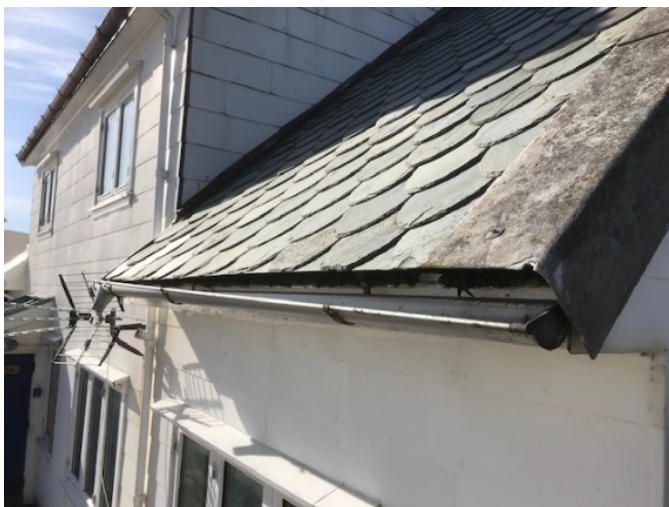
Denne delen av takrenne er ny og skal spares og brukes på samme plassen.
