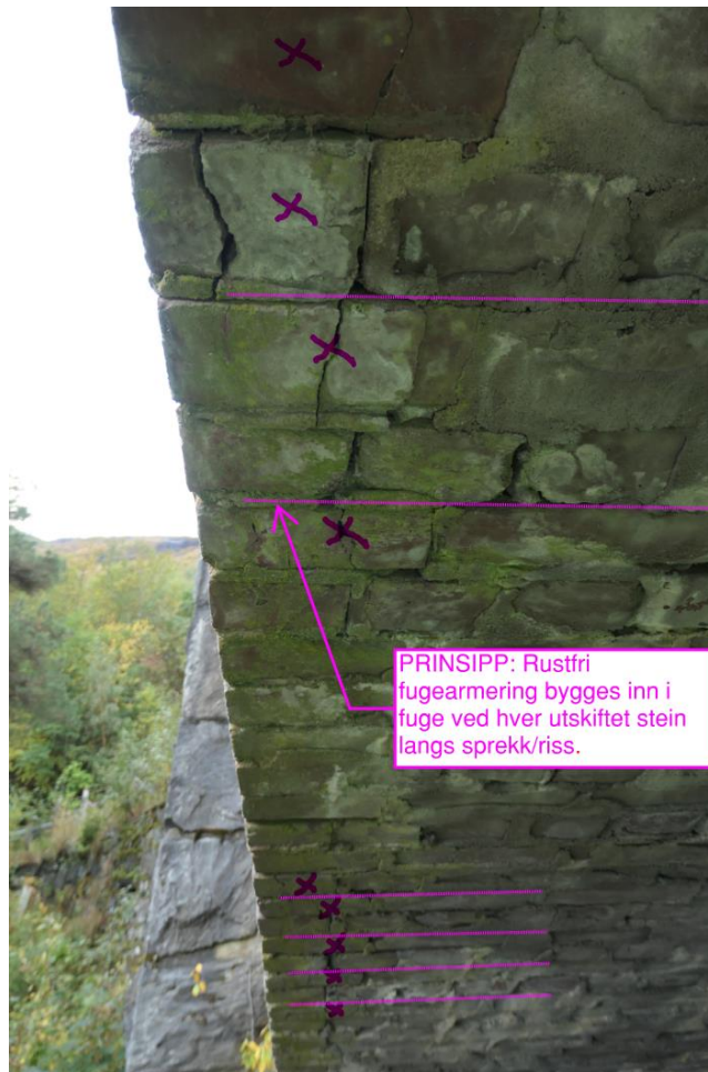
Figur 12 Riss/sprekk langs hvelvunderside ved hvelvkant. Prinsipp for omfang av skadede stein som skal skiftes og plassering av fugearmering. Markering med kryss indikerer at teglstein skal utskiftes.
