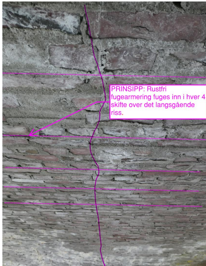
Figur 13 Riss langs hvelv underside som ligger sirka midt på hvelvbredde. Prinsipp for plassering av fugearmering.
