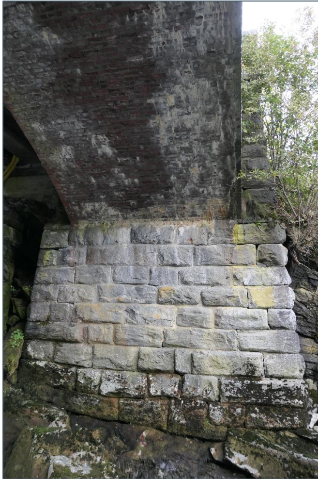
Figur 15 Natursteinvegg på landkar. Tomme fuger repareres på tilgjengelige overflater i dagen ved begge landkar.
