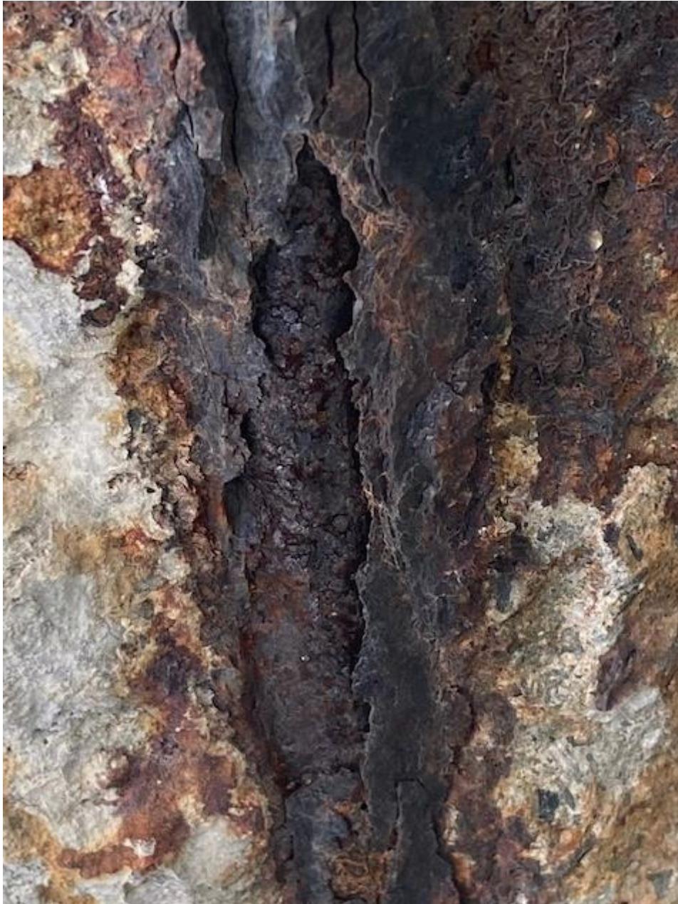
Korrosjon på armering
