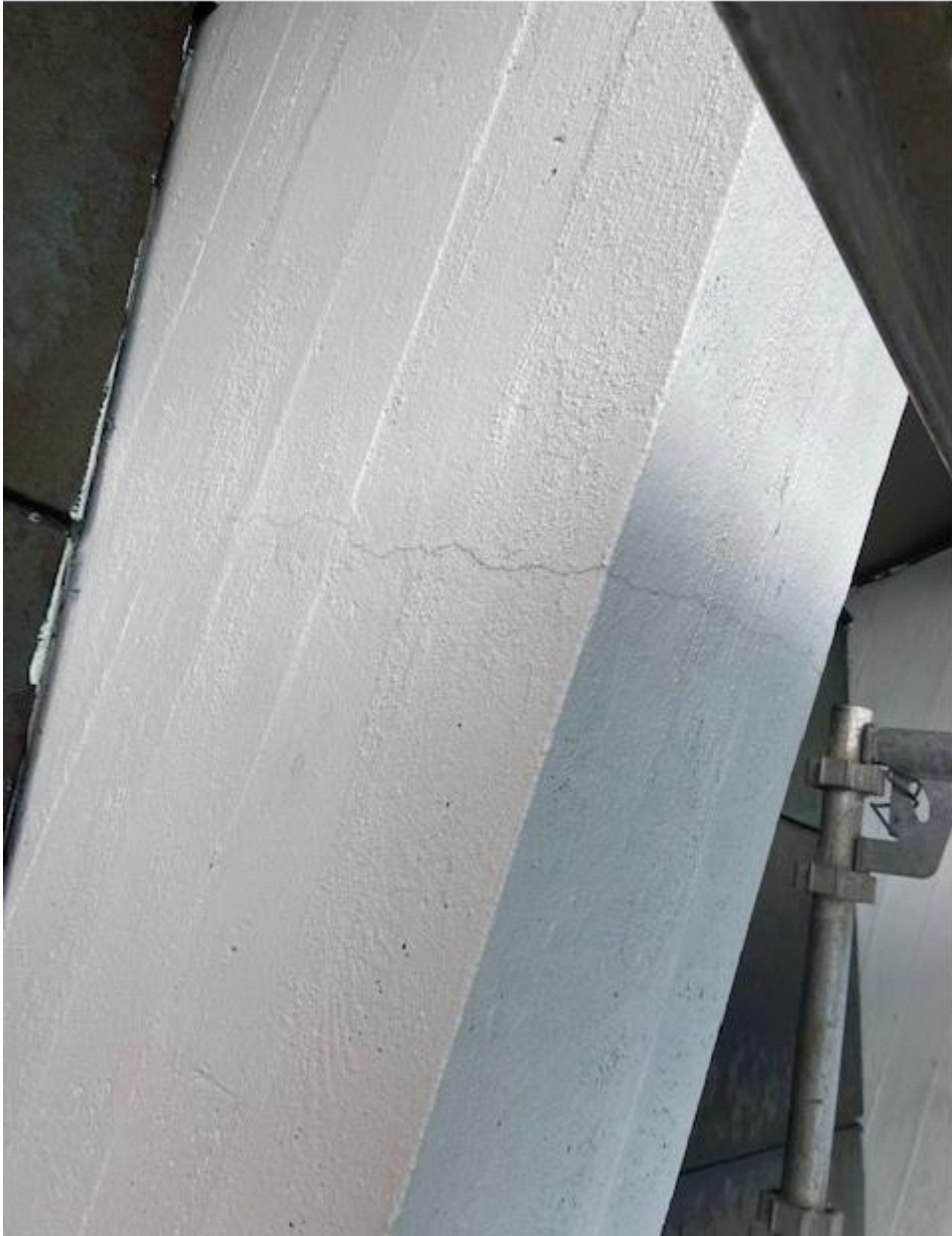
Riss i søyle
