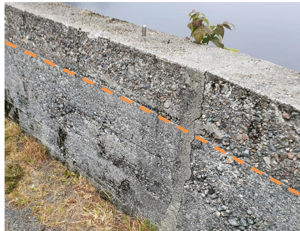
Figur 7 Svartatjørna. Foto av lagdelingen i brystningen på dammen. Foto er tatt mot nord.
