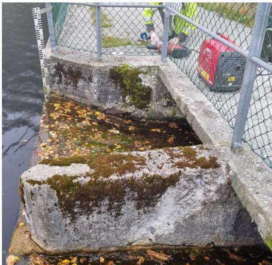
Figur 4 Dam Storavatnet. Bildet viser overløpet som skal rives. Foto tatt mot sør.
