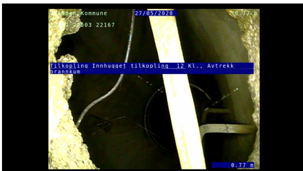
Foto: L22503_22167_22162_27052020_5_3_0,766_U.JPG, 00:00:04 0,77m, Tilkopling Innhugget tilkopling 12 Kl., Avtrekk brannkum
