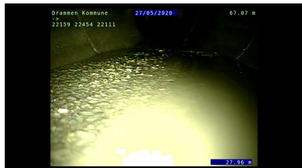
Foto: L22454_22159_22111_27052020_3_4_27,958_D.JPG, 00:03:03 27,96m, Sedimentering, dybde på avsetning er mellom 5-15%, fra 05 til 07 Kl., Fine masser (f eks sand, silt), Start
