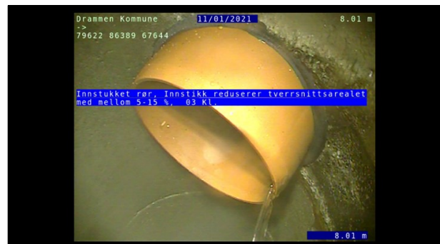
Foto: L86389_79622_67644_11012021_5_4_8,005_D.JPG, 00:02:19 8,01m, Innstukket rør, Innstikk reduserer tverrsnittsarealet med mellom 5-15 %, 03 Kl.
