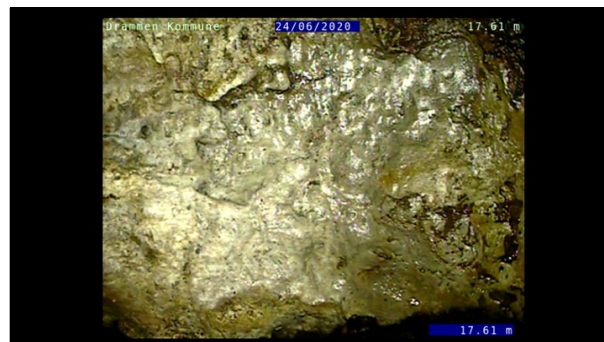
Foto: L67647_67644_22110_24062020_1_4_17,615_U.JPG, 00:03:21 17,61m, Utfelling/Belegg, reduksjon i tverrsnittsarealet er 5% eller mindre, fra 01 til 06 Kl., Andre
