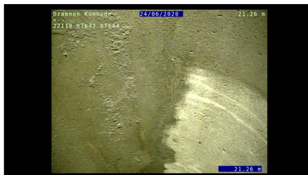
Foto: L67647_67644_22110_24062020_1_6_21,264_U.JPG, 00:04:51 21,26m, Sprukket rør, overflatesprekker,avskalling eller teglstein er delvis løse, 12 Kl., Langsående
