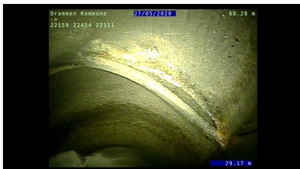
Foto: L22454_22159_22111_27052020_3_5_29,168_D.JPG, 00:03:29 29,17m, Synlig pakning, Andre pakningsmaterialer reduserer tverrsnittsarealet med mellom 15 - 30%., fra 01 til 05 Kl.
