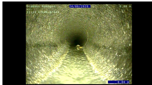
Foto: L67646_67644_22110_24062020_2_2_0,795_U.JPG, 00:00:15 0,8m, Korrosjon/Slitasje Synlig tilslag (rørveggen er betydelig påvirket), I betongrør er tilslagsmaterialet tydelig blottlagt, fra 12 til 12 Kl., Start
