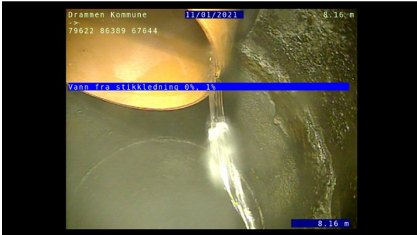
Foto: L86389_79622_67644_11012021_5_5_8,161_D.JPG, 00:02:41 8,16m, Vann fra stikkledning 0%, 1%
