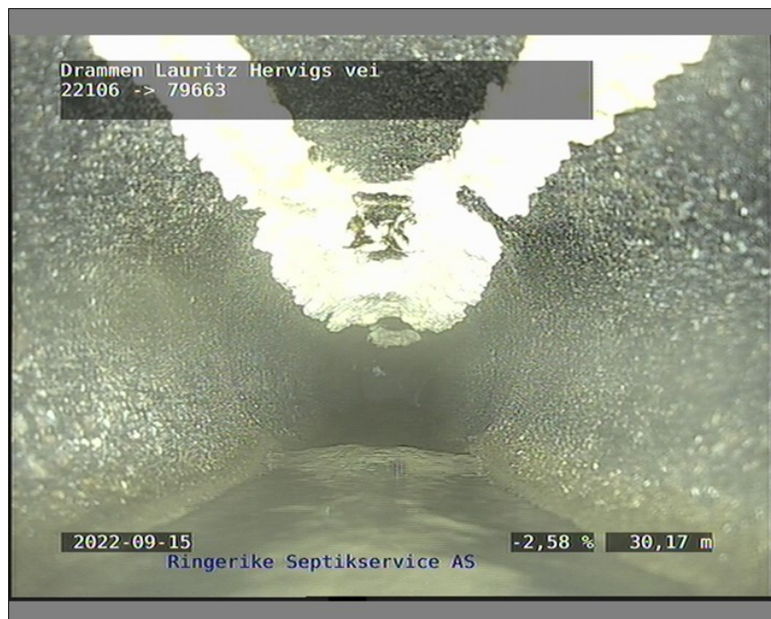
Foto: L57807_22106_79663_20220915_1_8_30,173_D_A.JPG 30,17m, Utfelling/Belegg, reduksjon i tverrsnittsarealet er mellom 5 - 15%, fra 11 til 01 Kl., Fett
