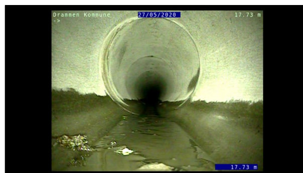
Foto: L22501_22161_22159_27052020_4_4_17,728_D.JPG, 00:01:41 17,73m, Sedimentering, dybde på avsetning er 5% eller mindre, 06 Kl., Fine masser (f eks sand, silt)
