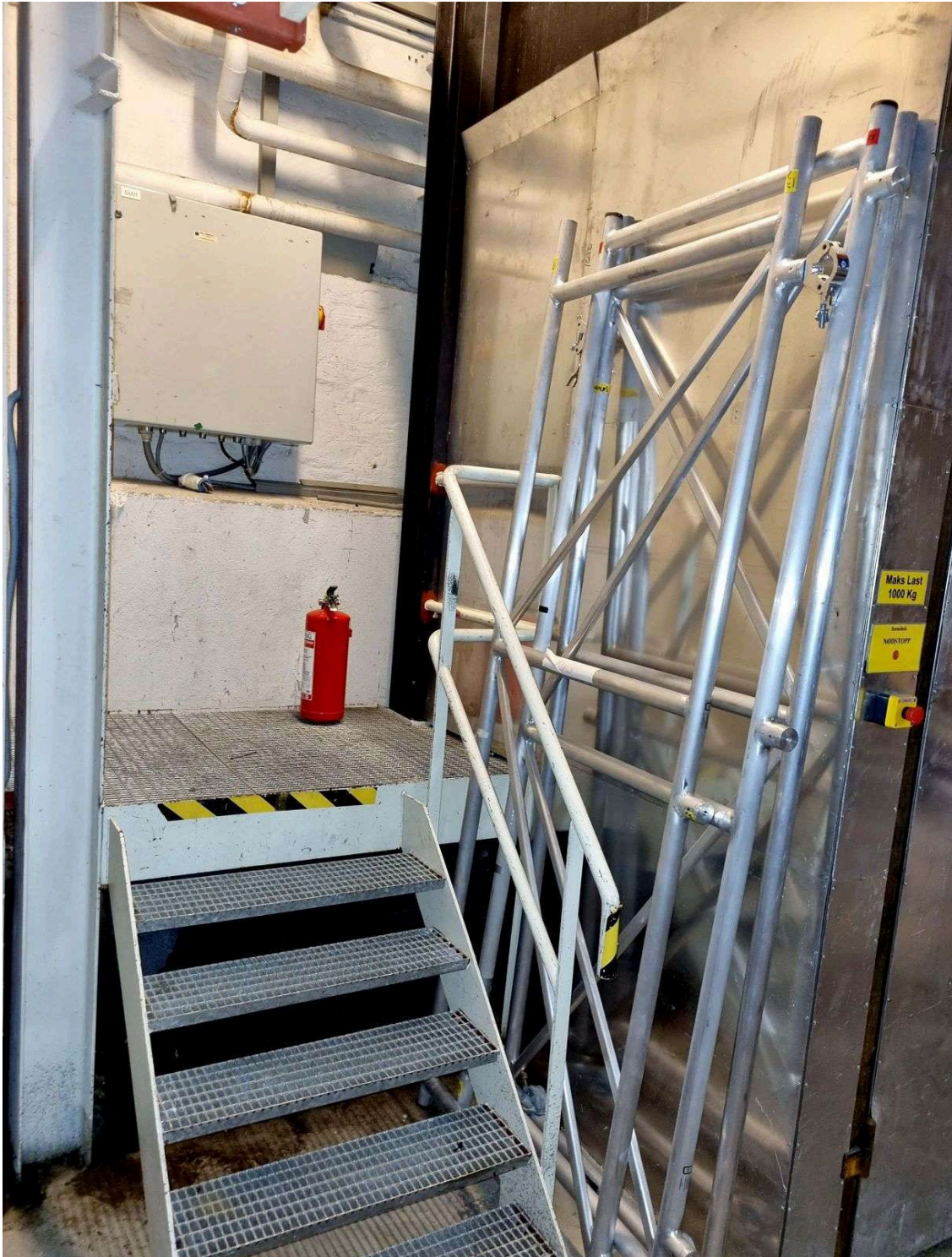
Figur 2 Trapp med (maskinrom) styreskap over, og aggregat under
