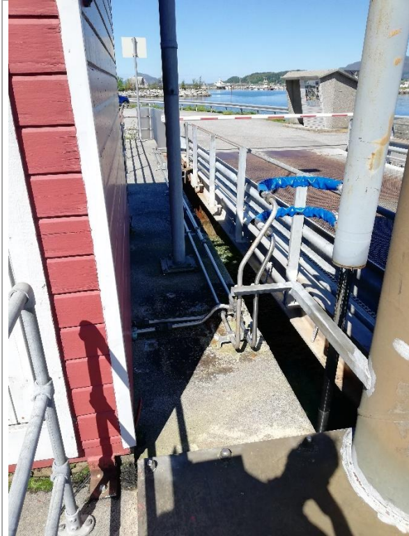
Bilde 9: Rør til hydraulikkolje
