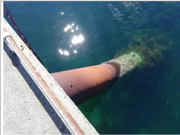
Bilde 25: Stag i kaikonstruksjonen.
