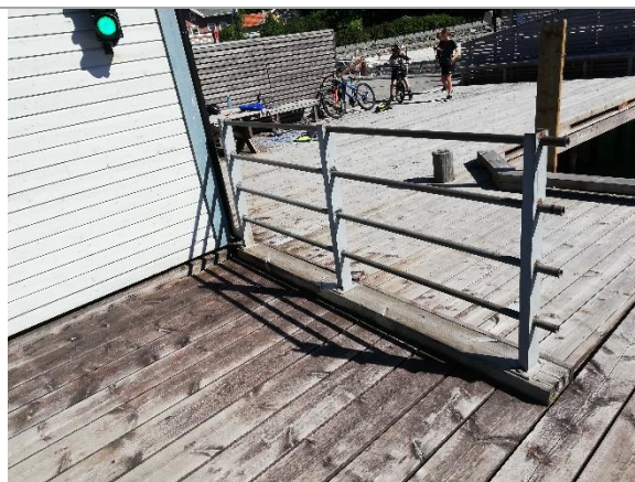
Bilde 17: Skille mellom trykkimpregnert på øst siden av rekkverk, og kreosotbehandlet på vest og sør-siden.
