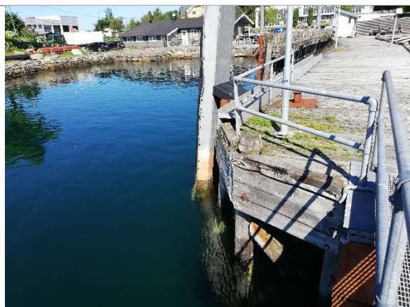
Bilde 15: Kreosotbehandlet trevirke brukt til kaikonstruksjon.
