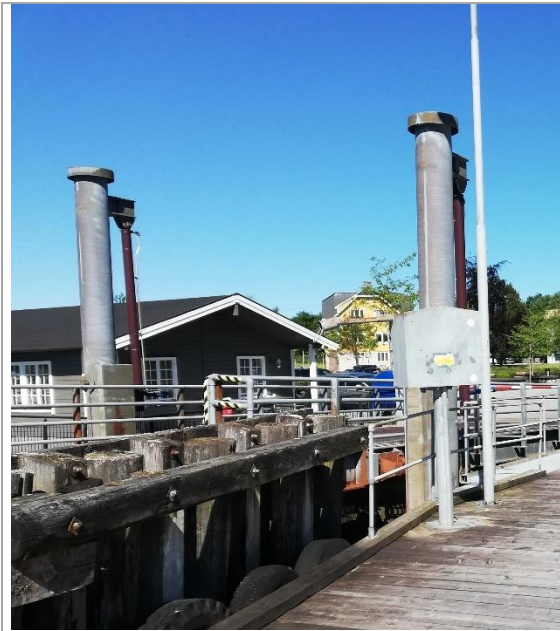
Bilde 12: Hydraulikk løftetårn til fergebokai
