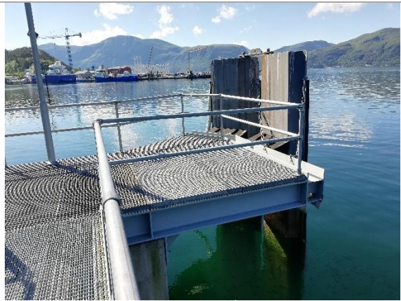
Bilde 31: Fenderelement på dykdalb.
