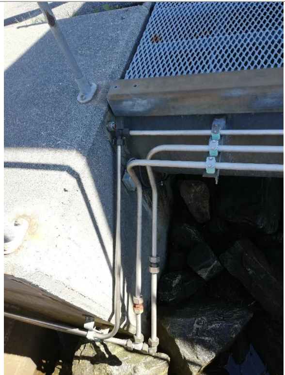
Bilde 13: Rør med hydraulikkolje.
