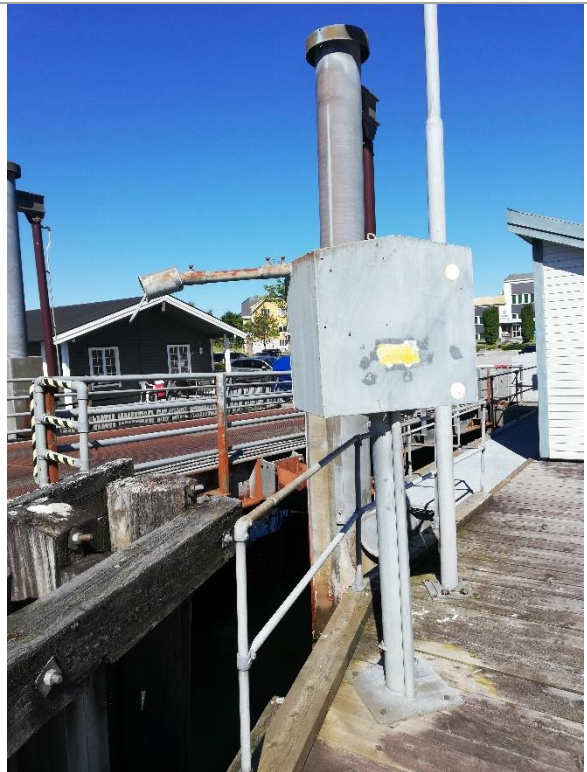
Bilde 41: Nødstrømtrommel, og rekkverk.
