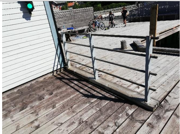
Bilde 8: Overgang mellom kreosotbehandlet- og trykkimpregnert trevirke ved enden av rekkverket.
