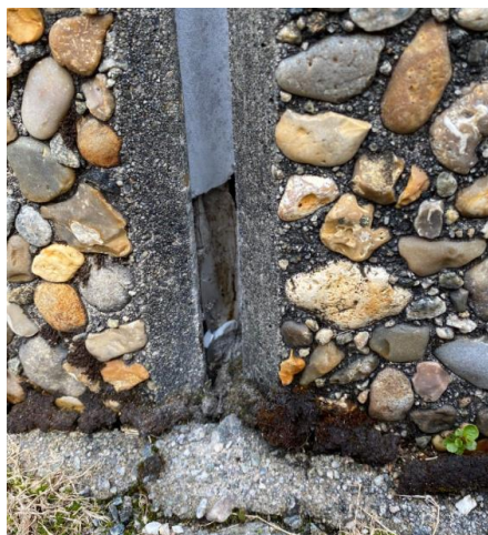
Bilde B6: Prøve nr P07 Fuge utvendig mellom betongelement
