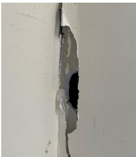
Bilde B3: Prøve nr P03 fuger innvendig mellom betongelement i filtersal
