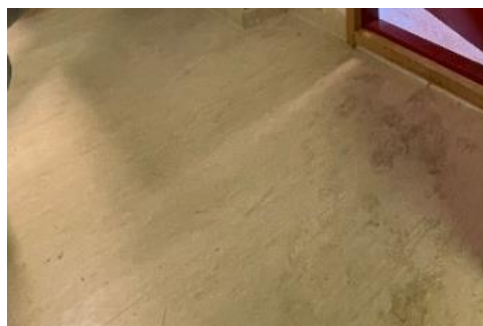
Bilde B12: vinylbelegg på ventilasjonsrom
