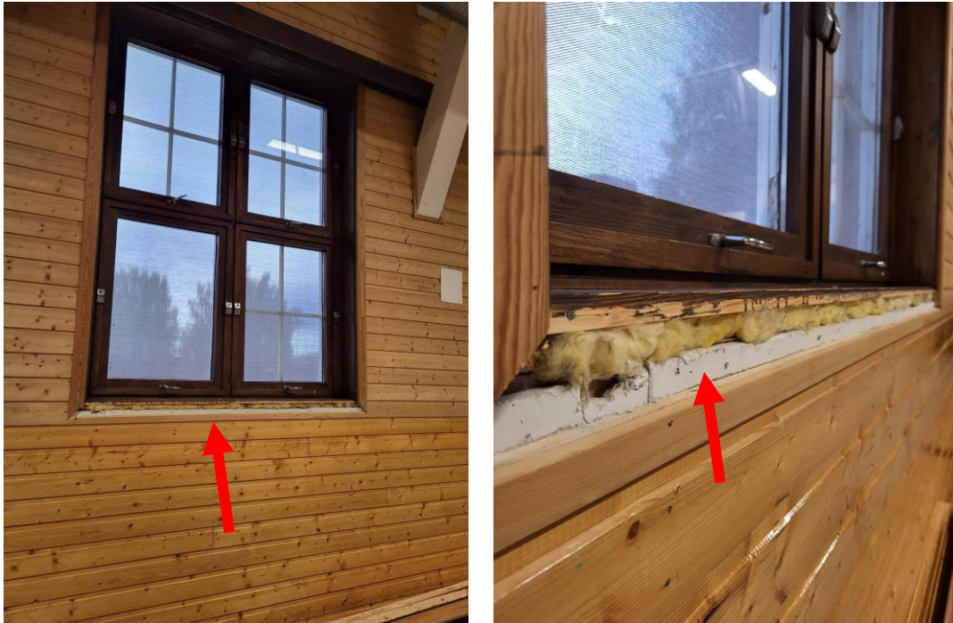
Figur 1. Prøvetatte bygningsplater bak trepanel i gymsal.
