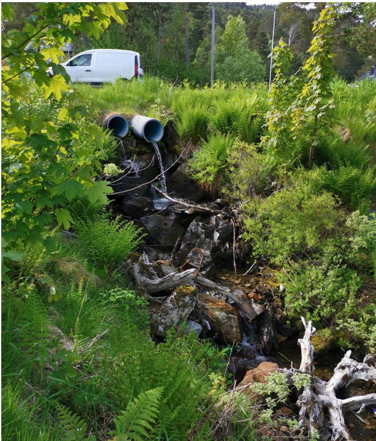
Figur 12. Bilde tatt i oppstrøms retning mot kryssingen av Myrdalsvegen. Dette er et absolutt vandringshinder, både for stor og liten fisk. Kulverter kan i noen tilfeller også hindre massetransport fra øvre del av nedbørsfeltet, men det må isåfall undersøkes nærmere. Dette ligger utenfor tiltaksområdet.
