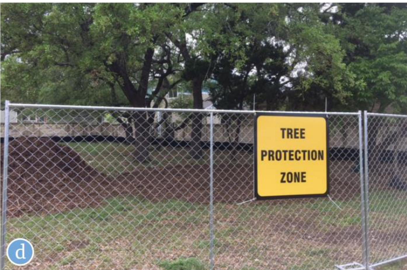
D) Best beskyttelse - Høye byggegjerder med god avstand til trærne. Godt informerte arbeidere og synlige informasjonsskilt, gir optimal beskyttelse for stamme, rothals, rotsone og trekrona. (foto. catheystreeservice)
