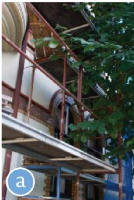
A) Ingen beskyttelse - Ubeskyttede greiner har stor sannsynlighet for å få skader under anleggsarbeid. I tilfeller hvor det ikke er praktisk mulig å sikre trekrona, er godt informerte arbeidere det beste tiltaket. (foto. Andreas Løvold/bymiljøetaten)
