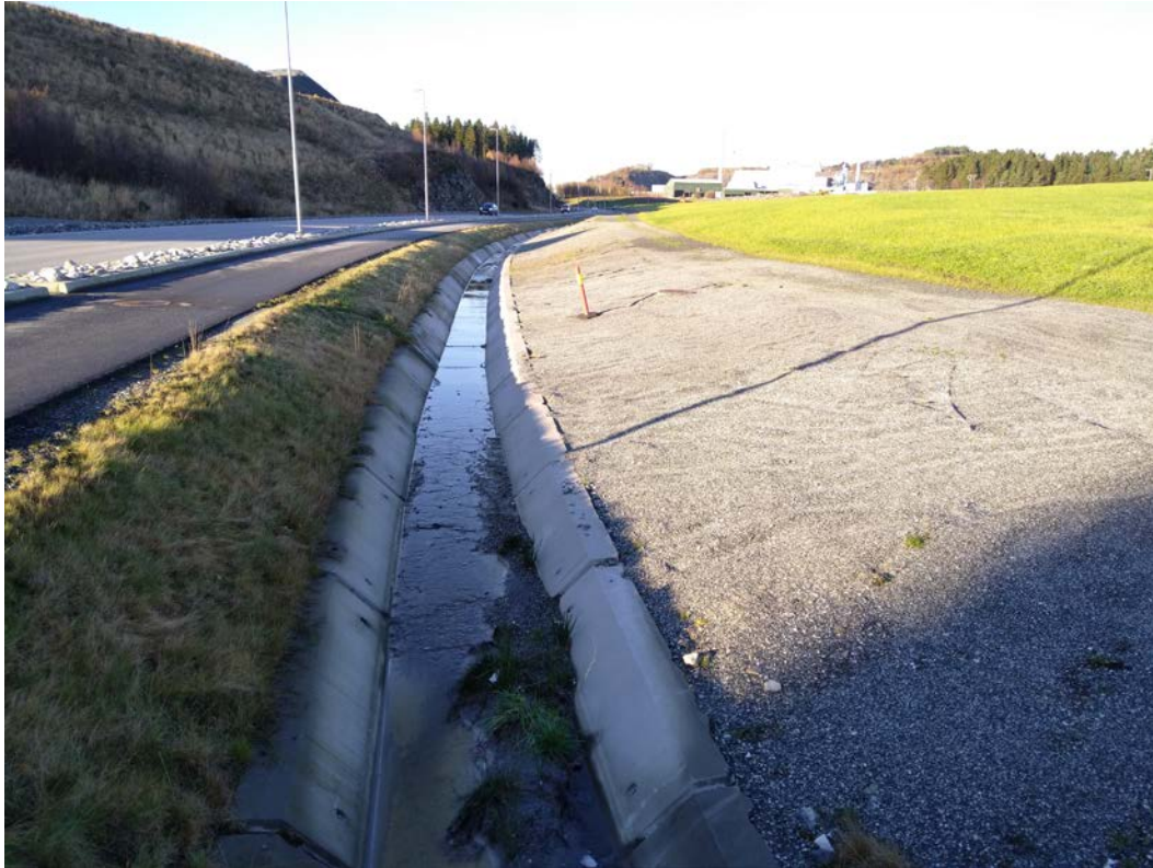
Figur 11. Overvann fra områdene rundt deponiet og til dels fra den rene overflate av deponiet ledes i en åpen kanal ned mot Melkeviken.
