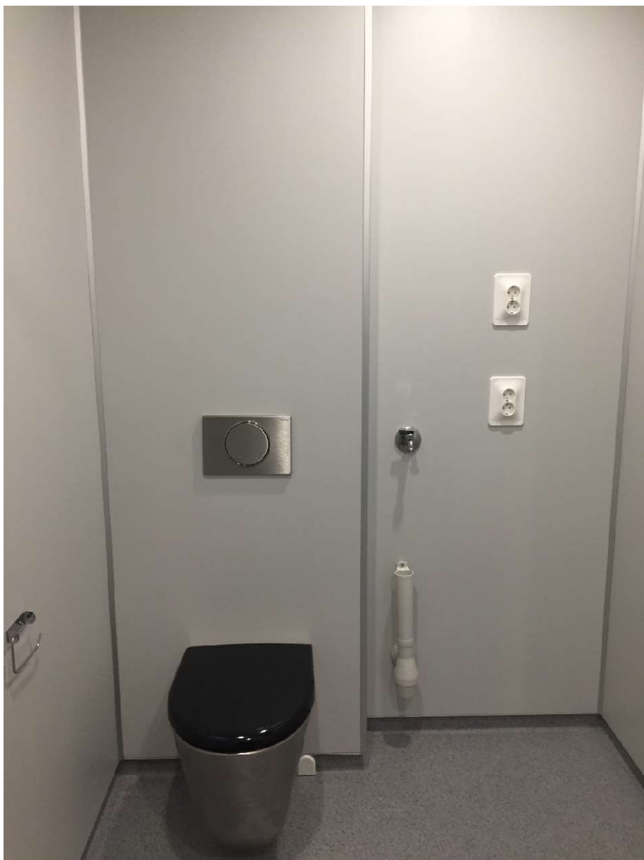
Baderom - WC, stikk på vegg, toalettrullholder, opplegg for vaskemaskin.
