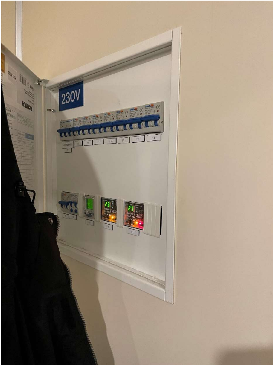
Fordelingseskab med termostater for varmekabler.
