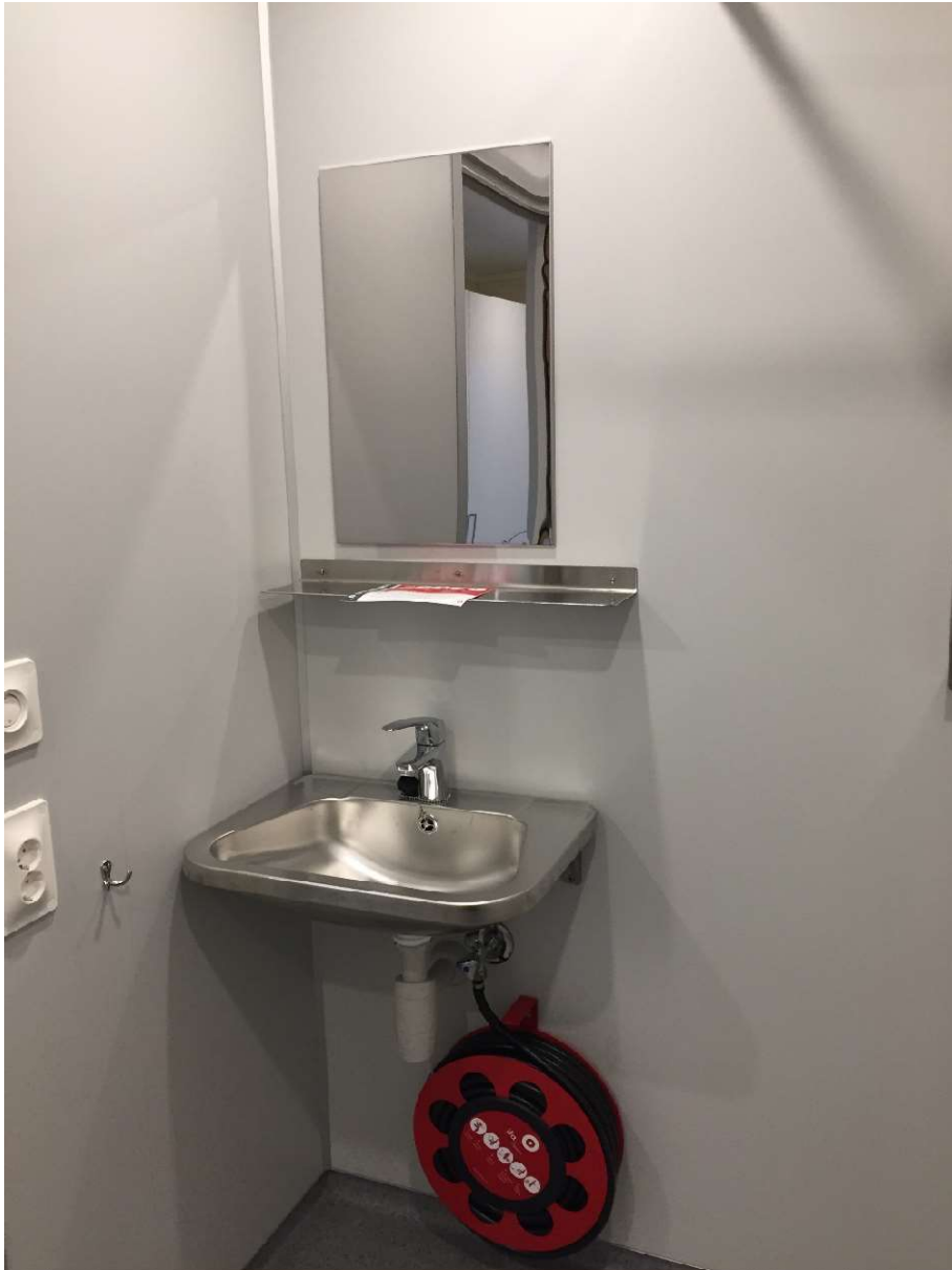
Baderom – Servant, speil m/hylle, brannslange, håndkleknagg
