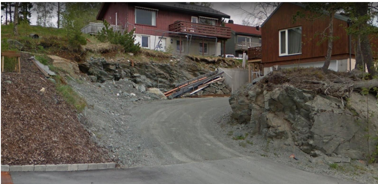
Figur 4-4 Anleggsarbeider ved Kyvannsvegen 25B viser hvordan resultat fra sprengning og/eller evt. pigging av berget i området kan bli. (Kilde: Google Street View, mai 2019)
