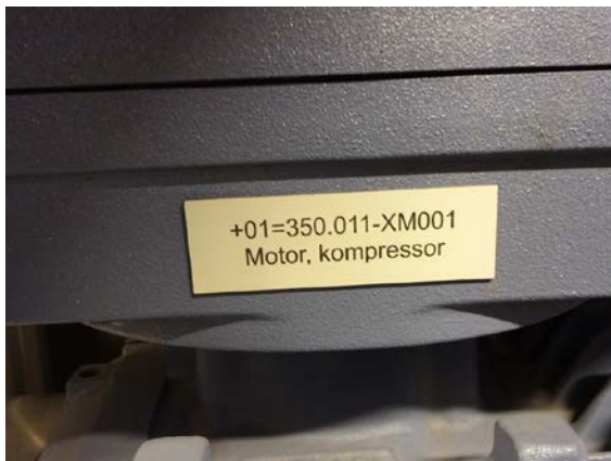
Eksempel på merking av en motor for kompressor. XM er komponentkode for elektromotor.
