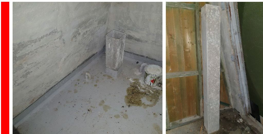
Figur 7-4 Eternitkanaler. Inneholder asbest.
