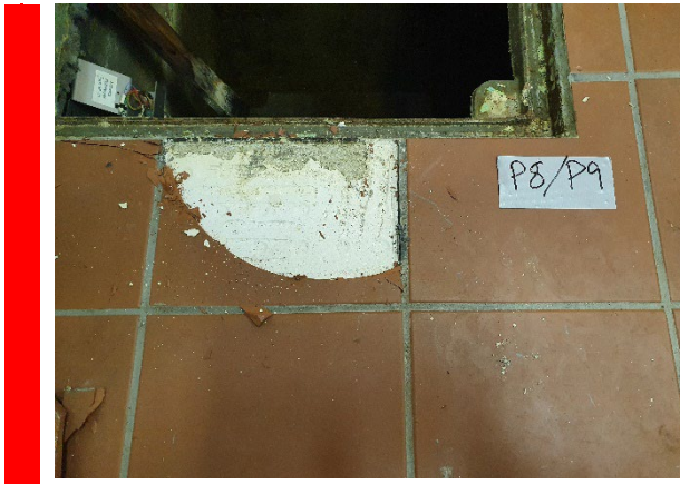
Figur 7-6 Avrettingsmasse/flislim under keramiske fliser i kjeller. Inneholder PCB over saneringsplikten (P8).
