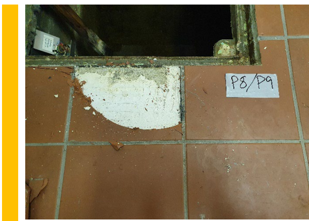
Figur 7-2 Avrettingsmasse/lim under gulvflis i kjeller. Inneholder ikke asbest, men PCB over grensen for farlig avfall. Se kapittel 7.4.2 for videre håndtering.
