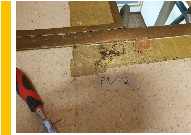
Figur 7-1 Verken linoleumsbelegget eller limet under dette inneholder asbest og kan håndteres som ordinært avfall.
