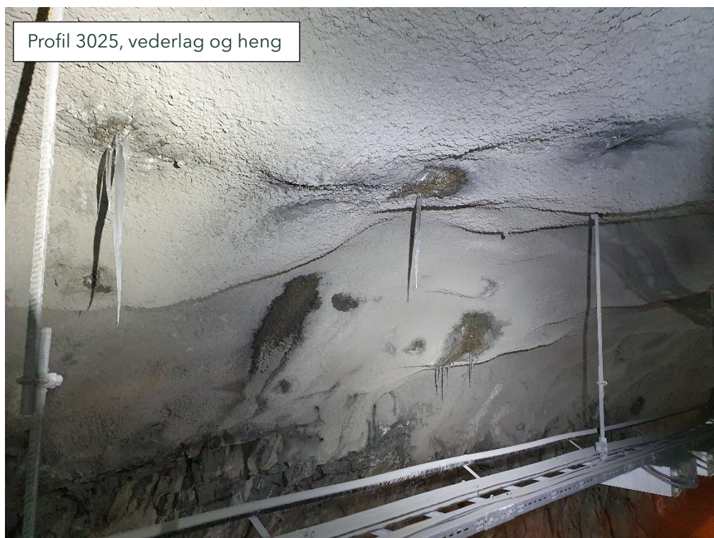
Figur 4: Fukt og is på sprøytebetong ved profil 3025. Bilde tatt mot synkende profilnr.
