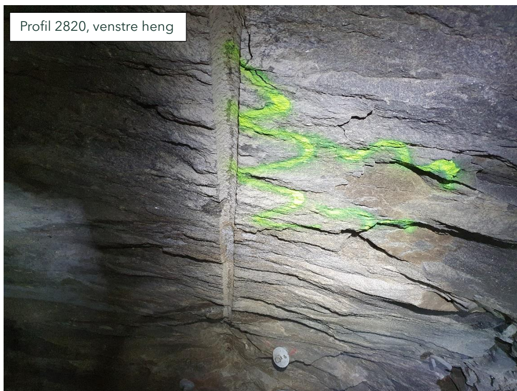
Figur 2: Små og veldig løse flak i heng der det anbefales strakstiltak i form av grundig rensk.
